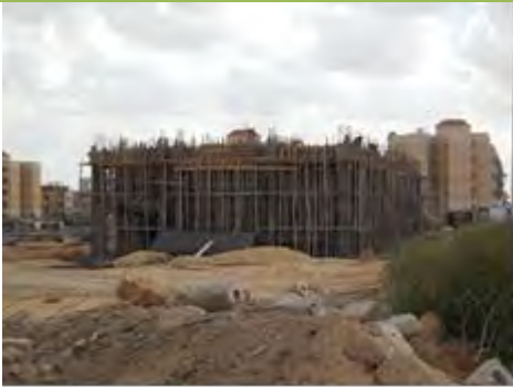
写真-3：E-JUST 敷地内で建設中の事務管理棟、2016 年以内に完成予定
