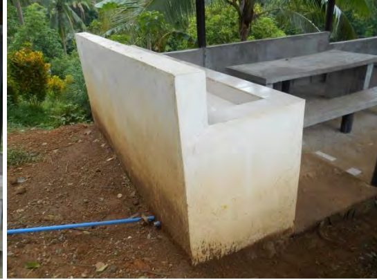
水の通っていない水道設備
