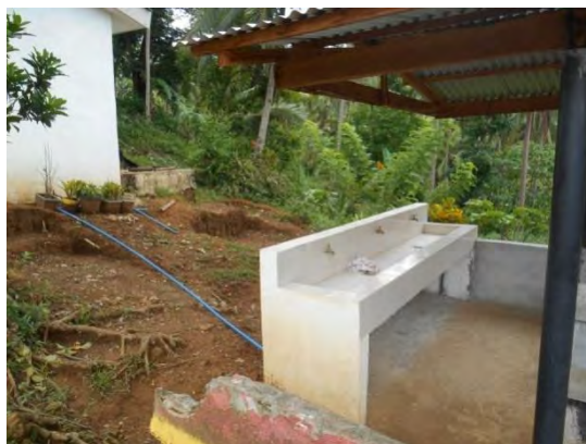
図 3.5 小学校の水道設備（通水なし）
