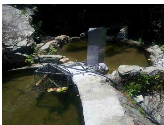
阿南高専製水車発電機
