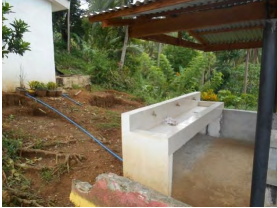
小学校の水道設備
