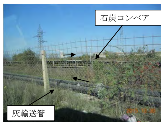
石炭コンベアと灰輸送管
