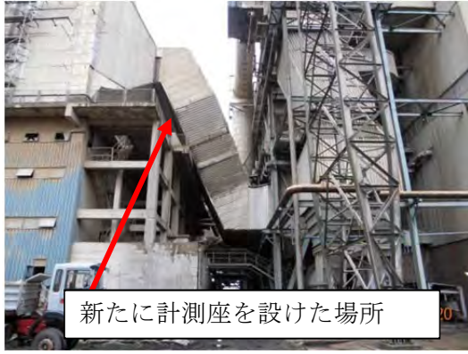
写真 4 - 4 a ESP 入側ダクト計測座
