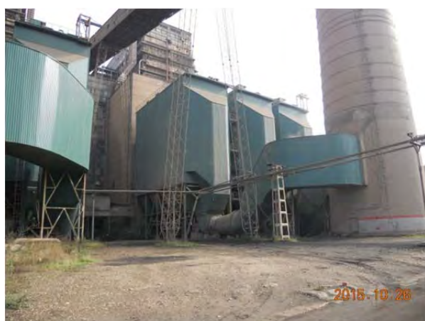
写真 3-12b 各ボイラに 3 基の ESP が 設置されている（A-3）
