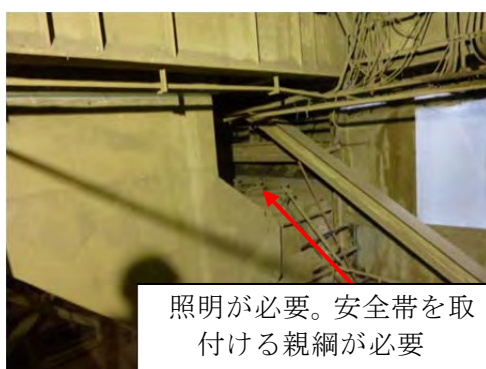
写真4-1a ESP入側ダクト計測座
