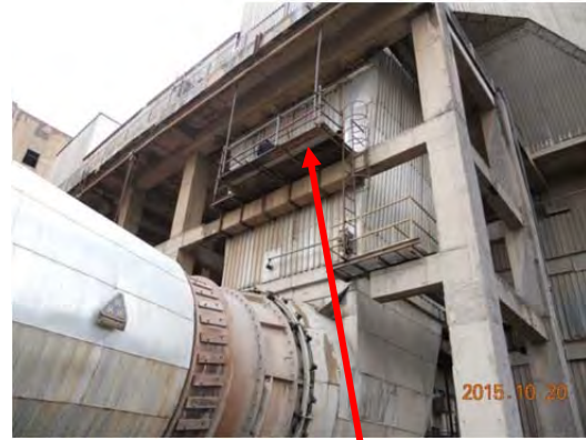
写真 4 - 4 b ESP 出側ダクト計測座
