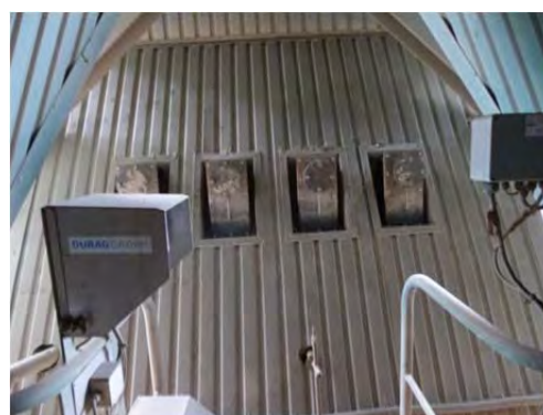
写真4-1b ESP出側ダクト計測座
