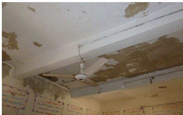
天井面全体に塗装の浮き、剥れが見られる。(Su04)
