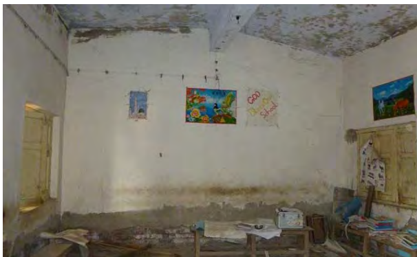
老朽化が進み使用されなくなった教室。浸水によるモルタル剥離、天井塗装の劣化等が見て取れる。(Gh04)
