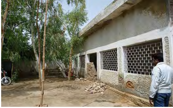
Kh11 GGPS Karim Bux Bhambhro: 既存校舎は損傷が激しく危険なため閉鎖されている。
