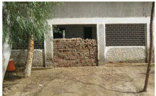
天井剥離等で危険な状態にあるため、立入りができないよう入口をふさいでいる。(Kh11)
