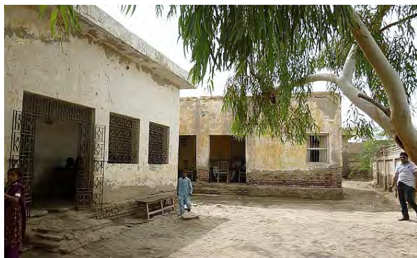
La02 GGPS Nai Gudd: 既存校舎は老朽化のため撤去予定
