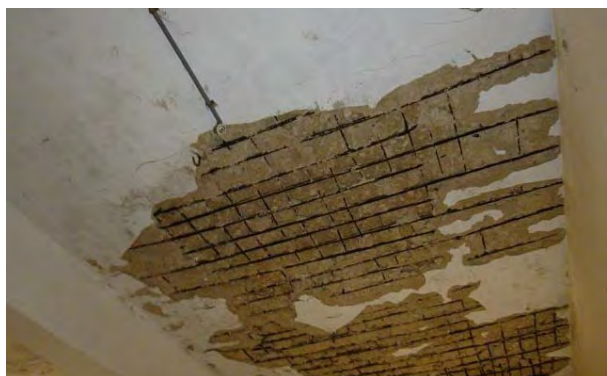
屋根スラブ見上げ面のコンクリート剥落により鉄筋が露出している。最も広く見られる不具合。(La03)
