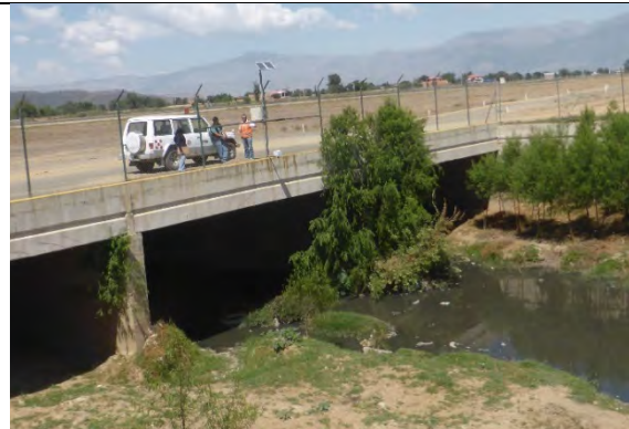
空港内を横切るロチャ川に設置された水位計
