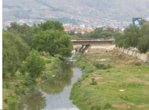
ロチャ川の様子(コチャバンバ市内) 河道内の橋梁アバットが河積を阻害している。
