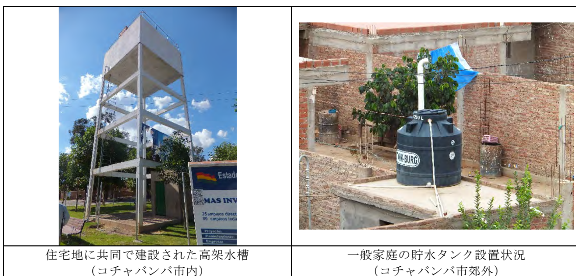
図 4-5-2 コチャバンバ市における給水用高架水槽および貯水タンクの例
