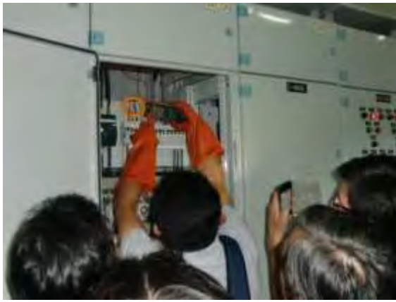
電源盤の電力測定（グループ B）
