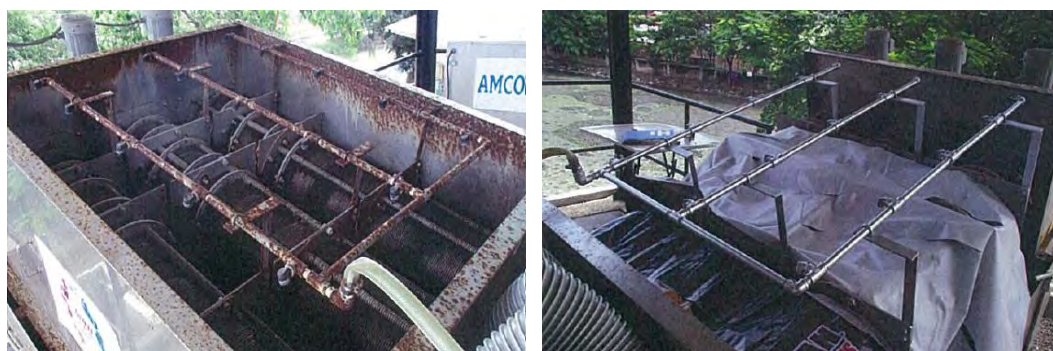
図 16：錆が発生した機材と、その後錆止めを施した様子（2014 年 8 月渡航時）
