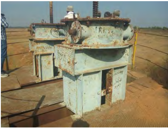
中規模灌漑地区の取水ゲート。老朽化により機能が低下しておりゲートの交換が必要である。(West Godavari 県)
