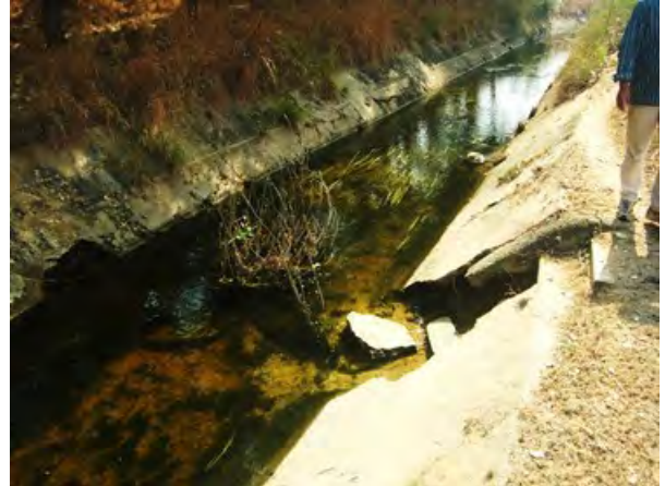
中規模灌漑地区の幹線水路。コンクリートライニングが崩壊した箇所は補修が必要である。(Chittoor 県)
