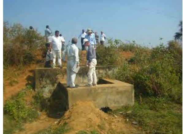
小規模灌漑地区の取水施設。砂質土壌のため土水路が崩壊しており、コンクリートライニングが必要である。(Vizianagaram 県)
