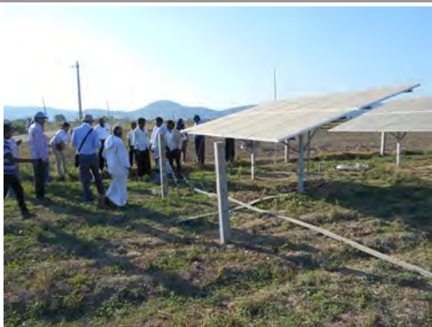
ソーラー式ポンプ灌漑施設。太陽光発電で地下水を汲み上げて灌漑している。(Guntur 県)
