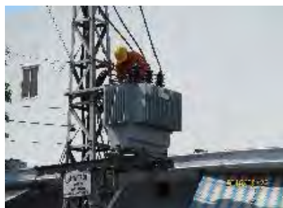
変圧器メンテナンス
