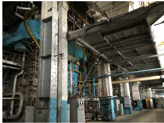
(ボイラ室の状況2)
