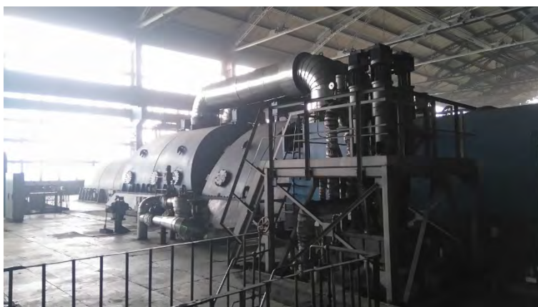
図 5.2-2 No.4 蒸気タービン
