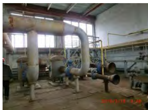
(ガス受入設備)
