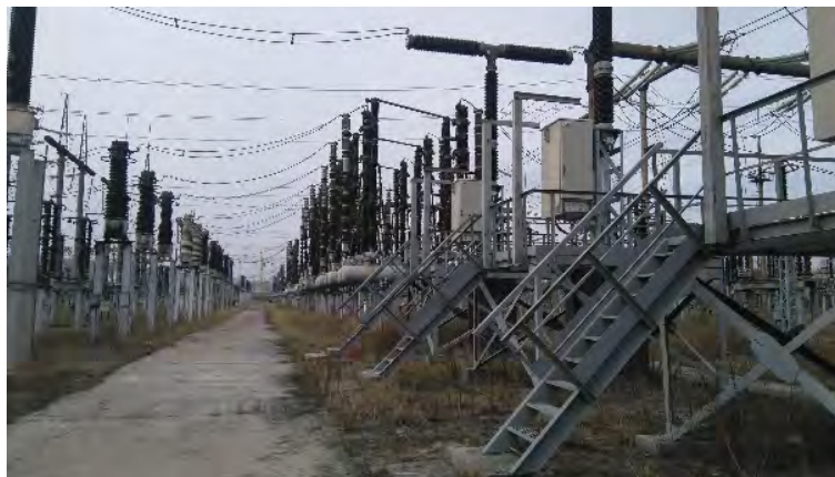
図 5.2-7 発電所の開閉所
