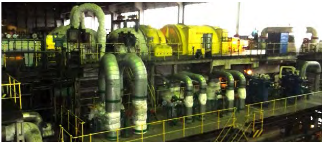
(No. 2 蒸気タービン (Skoda 製 PT-50-130、左から高圧、中低圧タービン、発電機))
