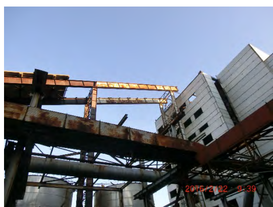
(設置済みコンベア)
