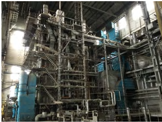
(ボイラ室の状況1)
