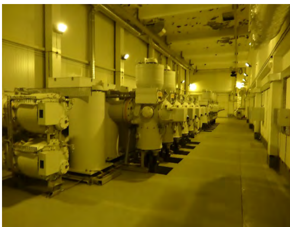
図 6.4-1 屋内設置 110 kV GIS
