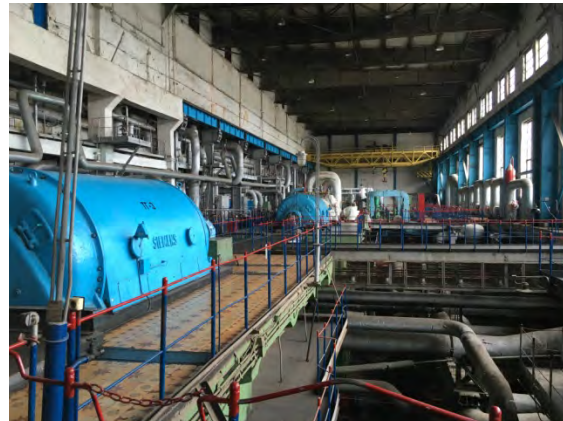
(Siemens 製復水タービン)
