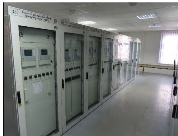
図 6.4-2 最新式デジタル保護継電器盤
