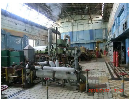
(タービン発電機)
