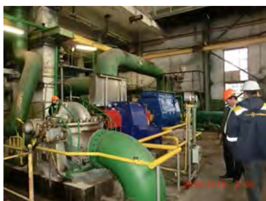
(温水供給ポンプ)
