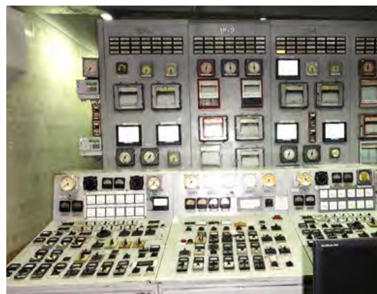
(ボイラ操作盤 (部分的にデジタル表示に更新))
