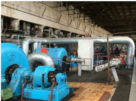
(No. 1/2 蒸気タービン)
