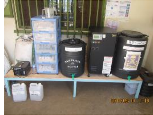
ユニット型電解水生成装置設置状況
