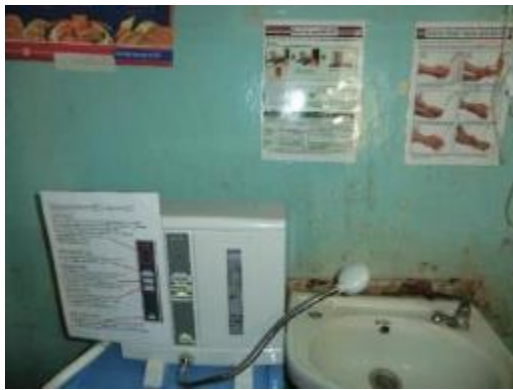
手指洗浄装置の設置状況
