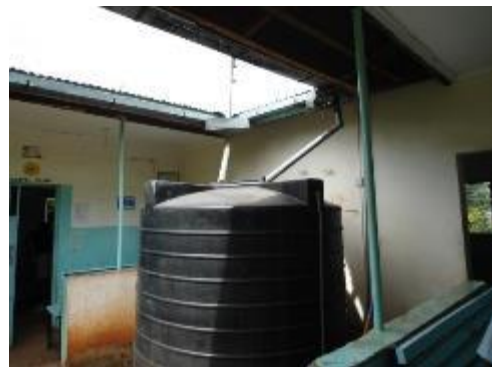
雨水利用タンク
