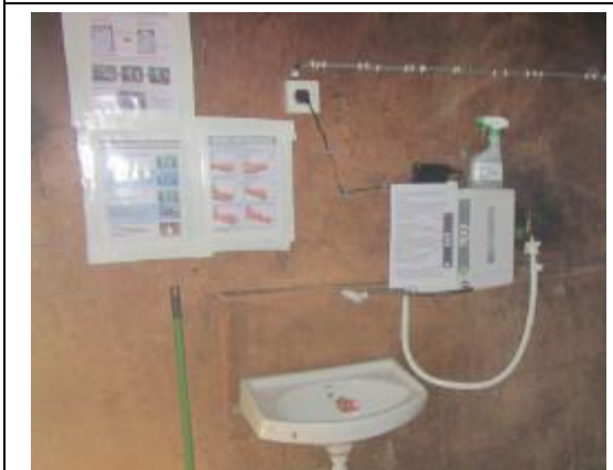
セントラルキッチン設置状況
