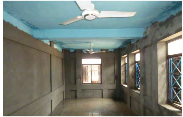
ネパール： 既存建物耐震補強工事(国家政策) 配筋後のモルタル塗り。大震災後も崩壊していない
