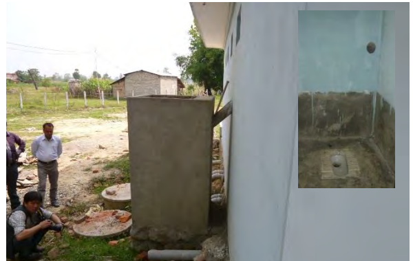
ネパール： 屋外に焼却炉設置され女子便所からの生理用品 投入シューターにて直接接続している
