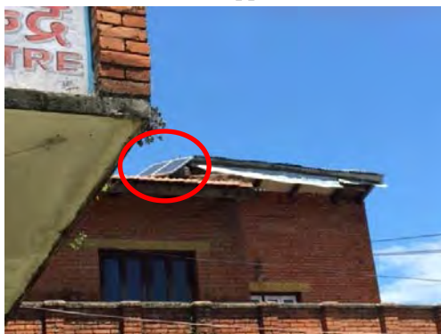
図 23 地域の医療機関（PHC）の屋根に設置してあるソーラーパネル
