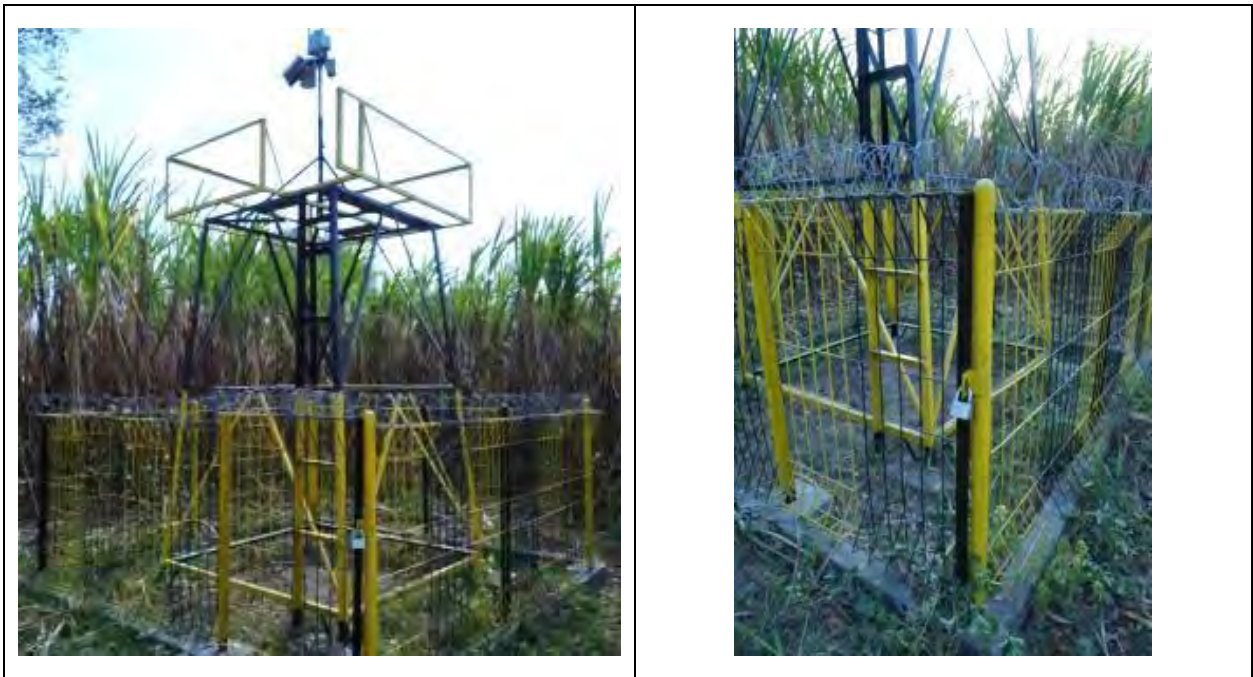
図 26 気象観測装置設置の保安設備
