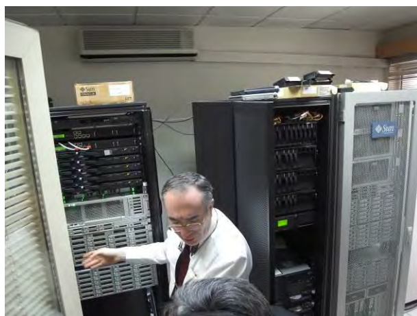
サーバー室（IT担当ドクターの執務室に設置）
