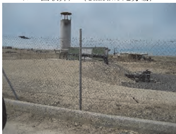
Landfill Gas の燃焼施設 (Ghabawi 処分場)
