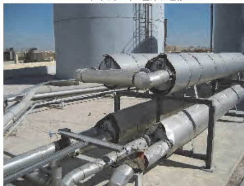
発酵層とガス回収パイプ
