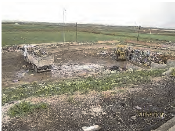
搬入されたごみは敷地内に降ろされ、Wheel Loader で Open-top trailer に積み替えられる。
