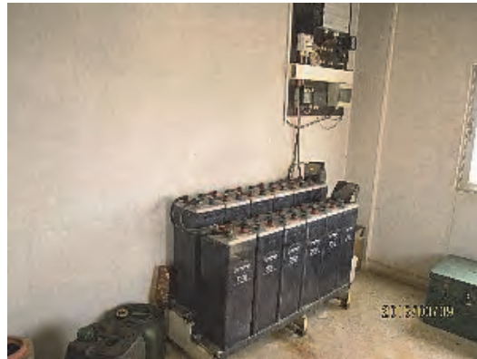
ソーラー発電で電気を確保している。
