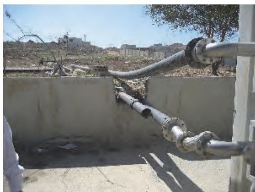
Landfill Gas の回収パイプ
