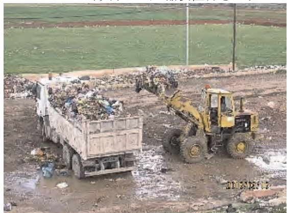
ごみの飛散防止柵がなく、周辺にごみが散乱している。
