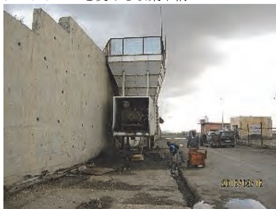
Al Shahinat TS (故障した圧縮装置付きホッパー)
