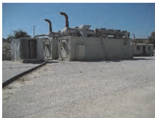
Module 型の発電施設
