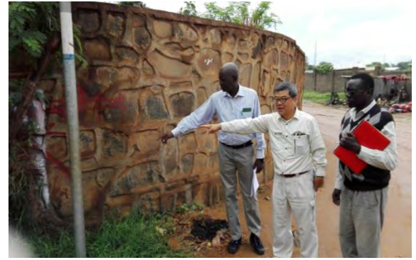
写真 B-4 障害物に関する現地確認状況 (橋梁 No.7) (2015年11月6日)
