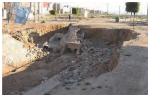
市内の洪水時の流水侵食による被害箇所。
