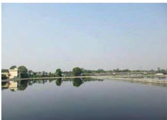
アグラ 78MLD の汚水処理場 上昇流嫌気性汚泥床-通性嫌気性ラゲ ーン (UASB-FPU) システム 広大な面積を要する FPU (2015 年 10 月 27 日)
