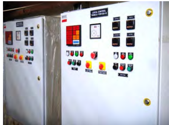
Badra Jassan No. 3 灌漑ポンプ場 新規制御盤の設置
