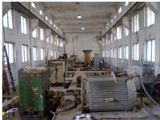
Shakha No. 13 排水ポンプ場 ポンプ室内の現況
