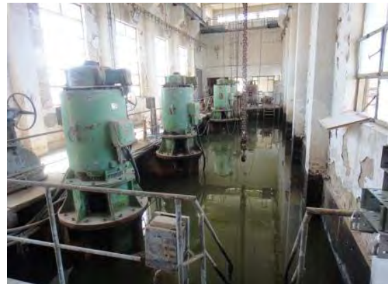
Shakha No. 8 排水ポンプ場 既存ポンプ室内の浸水状況
