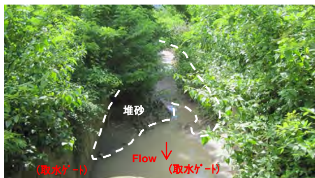
写真：取水ゲート上流の堆砂状況（2014年2月）
