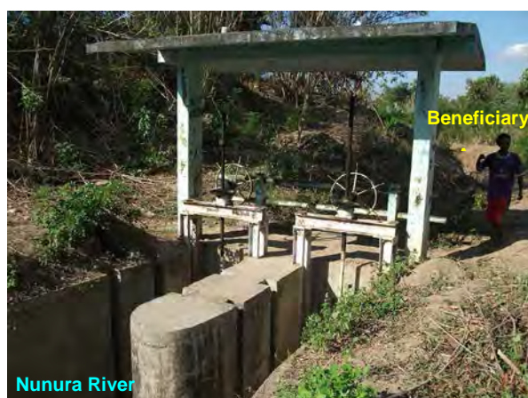
①ヌヌラ川からの取水用ゲート
