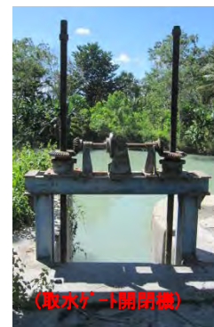
写真 取水ゲート開閉機の状況
