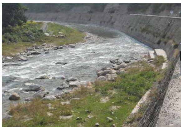
擁壁基礎付近の河川侵食（修復前）
