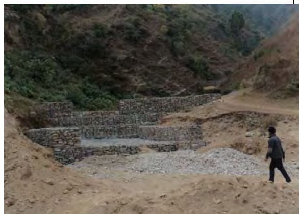
砂防ダムによる土石流対策
