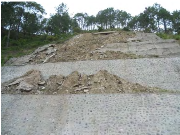
法面崩壊（修復前）
