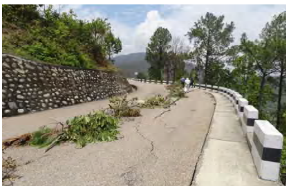
高盛土に発生したクラック
