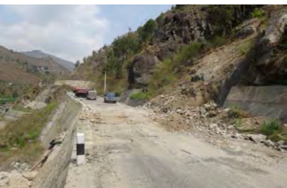
巨石落下による道路の損傷
