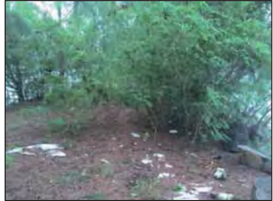
写真-32 防波堤天端面（岸壁-3）の状況
