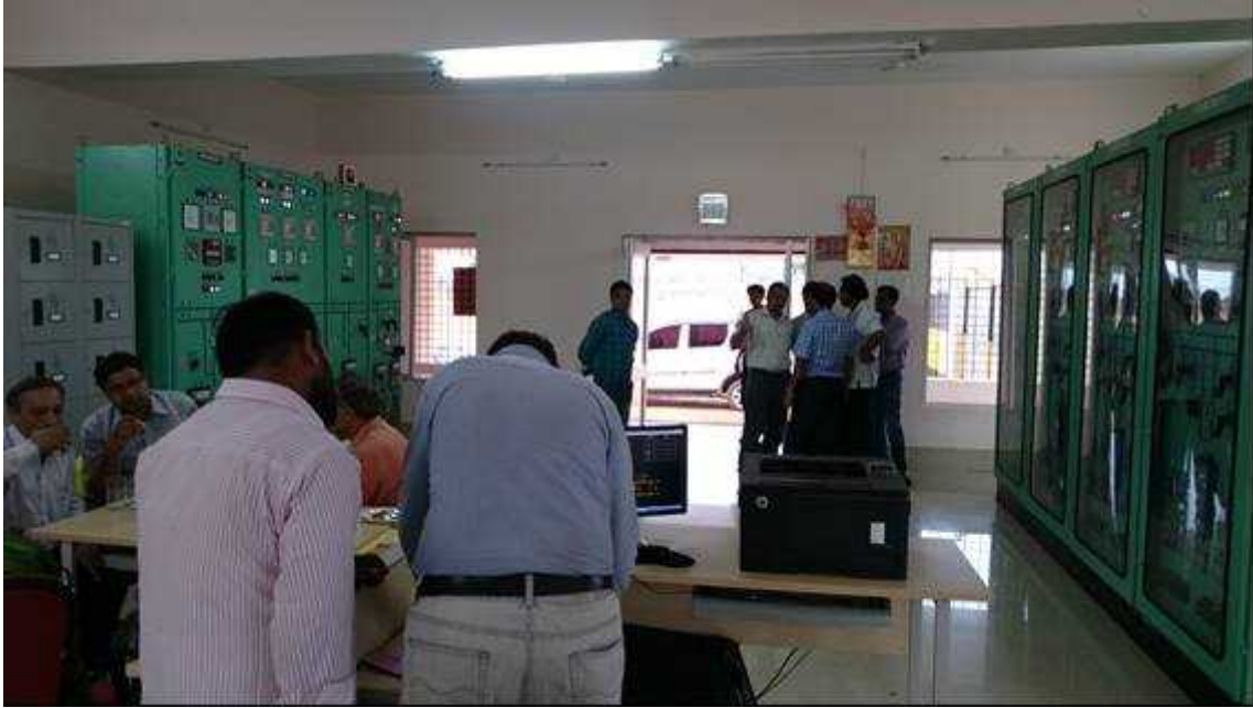
図 2-21 制御盤 (Tejgarh 132kV 変電所)
