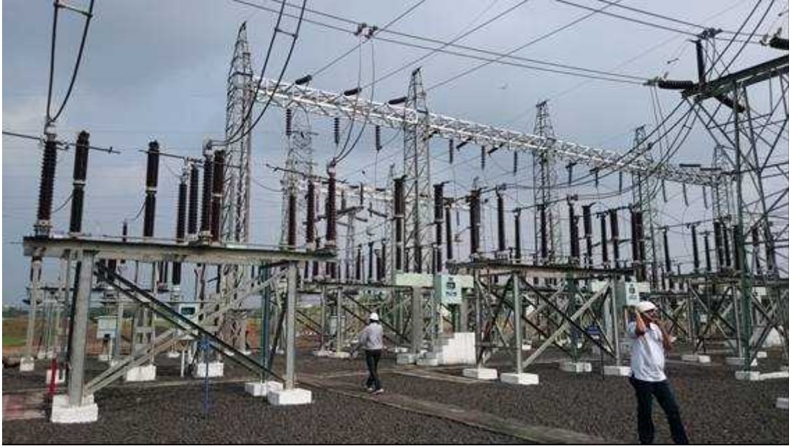
図 2-17 132kV 送電線引出し設備 (Marhotel 132kV 変電所)
