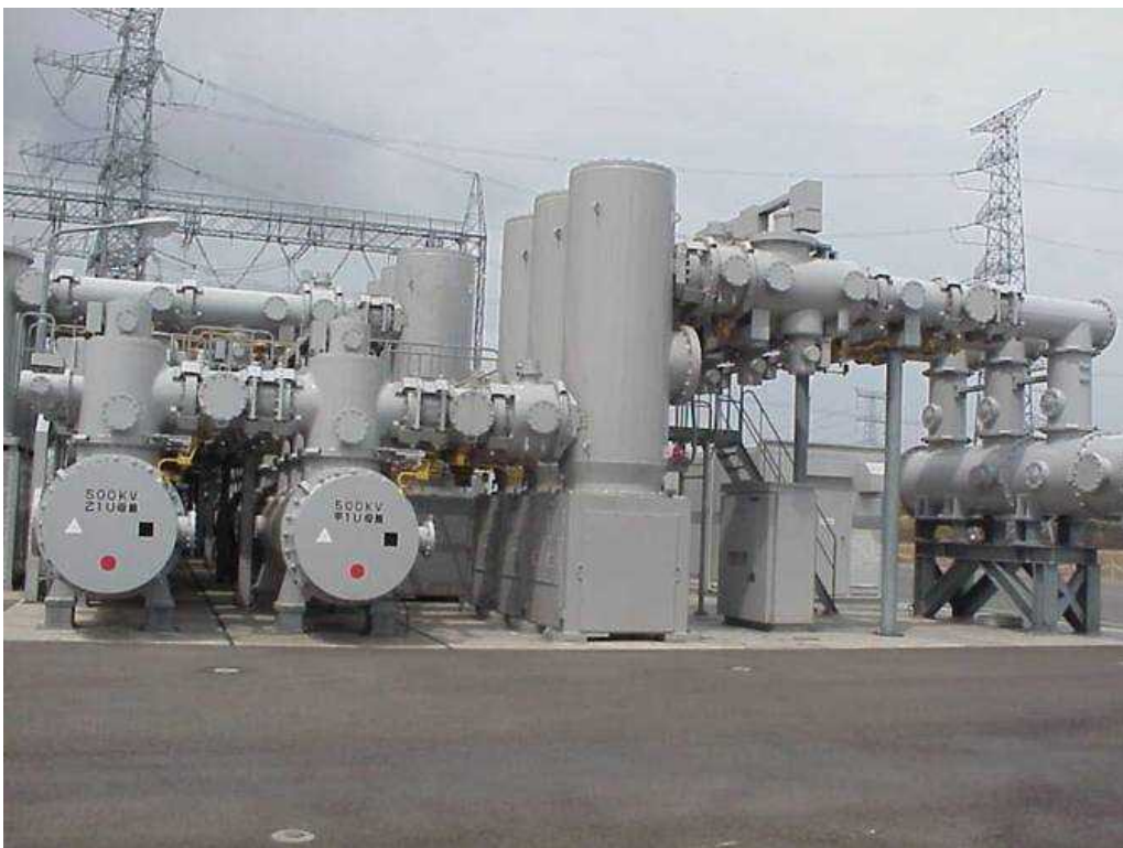
图 2-25 500kV 屋外 GIS 变电所 (東京電力)
