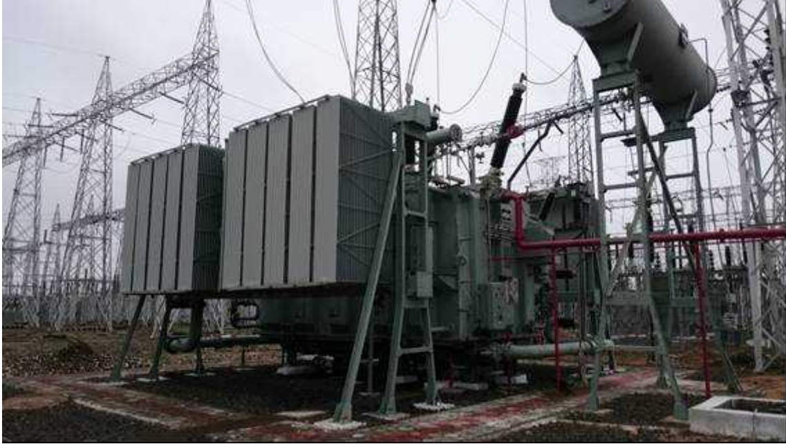
图 2-13 220/132kV, 160MVA 三相一括型变压器 (Jabalpur 220kV 变电所)
