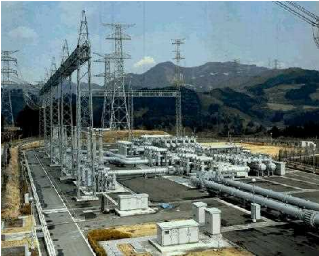
图 2-24 500kV 屋外 GIS 变电所 (東京電力)
