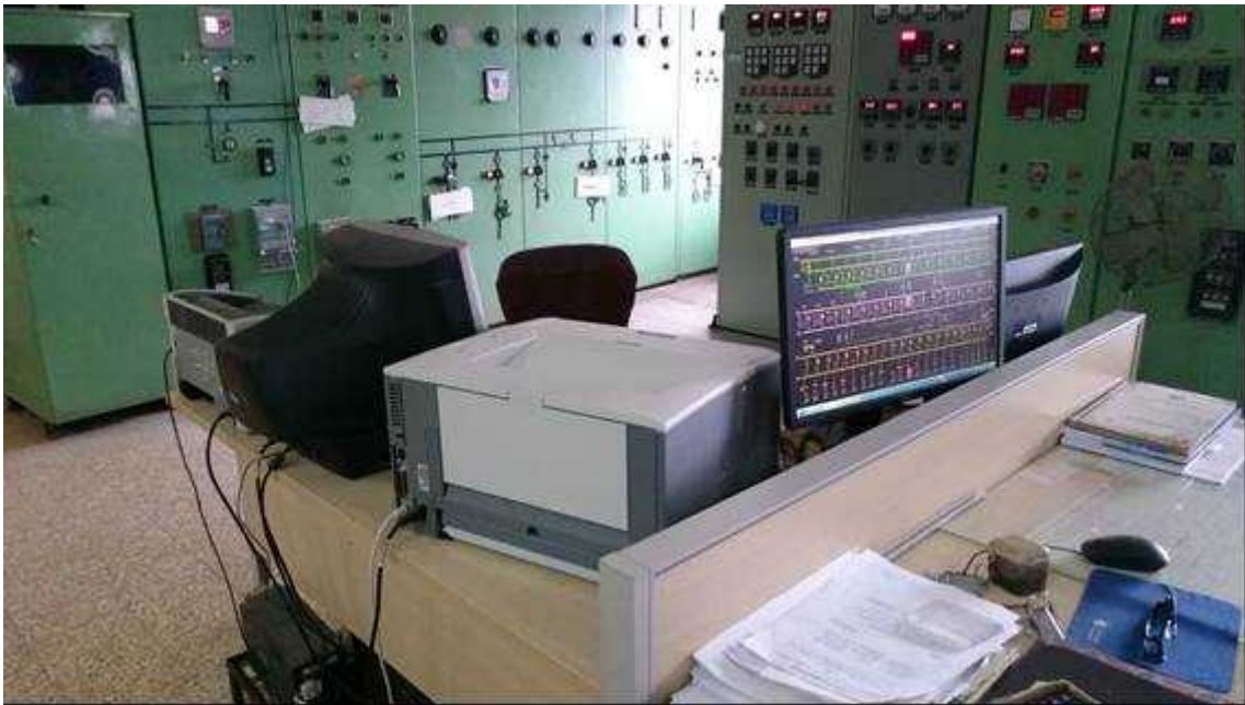
図 2-22 変電所 SCADA システム (Jabalpur 220kV 変電所)
