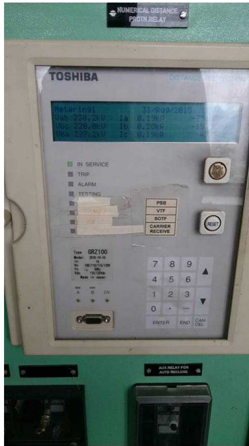
図 2-23 東芝製 220kV 送電線保護 Ry ユニット (Jabalpur 220kV 変電所)
