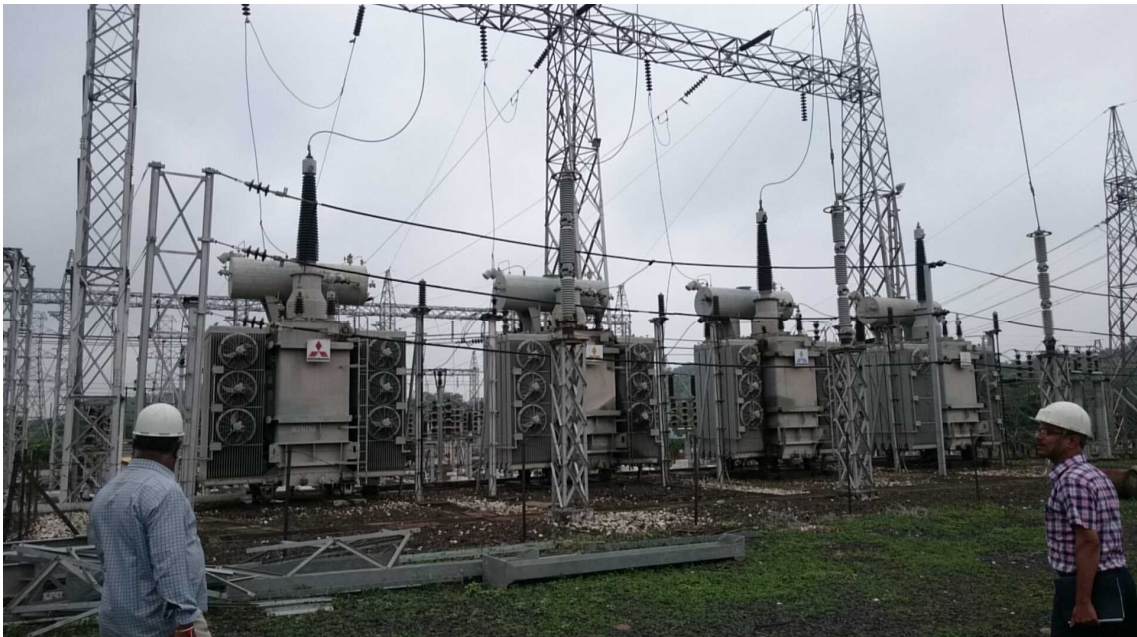
图 2-14 三菱电机製 220/132kV, 40MVA×3 单相变压器 (Jabalpur 220kV 变电所)
