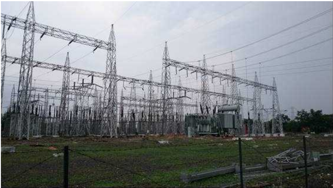
図 2-16 220kV 送電線引出し設備 (Jabalpur 220kV 変電所)
