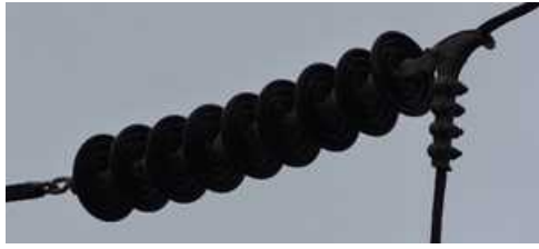
図 2-11 132kV がいし装置
