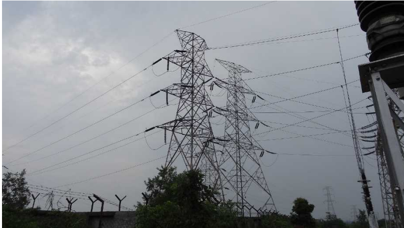
図 2-6 220kV 送電線 (Jabalpur 変電所引込鉄塔)
