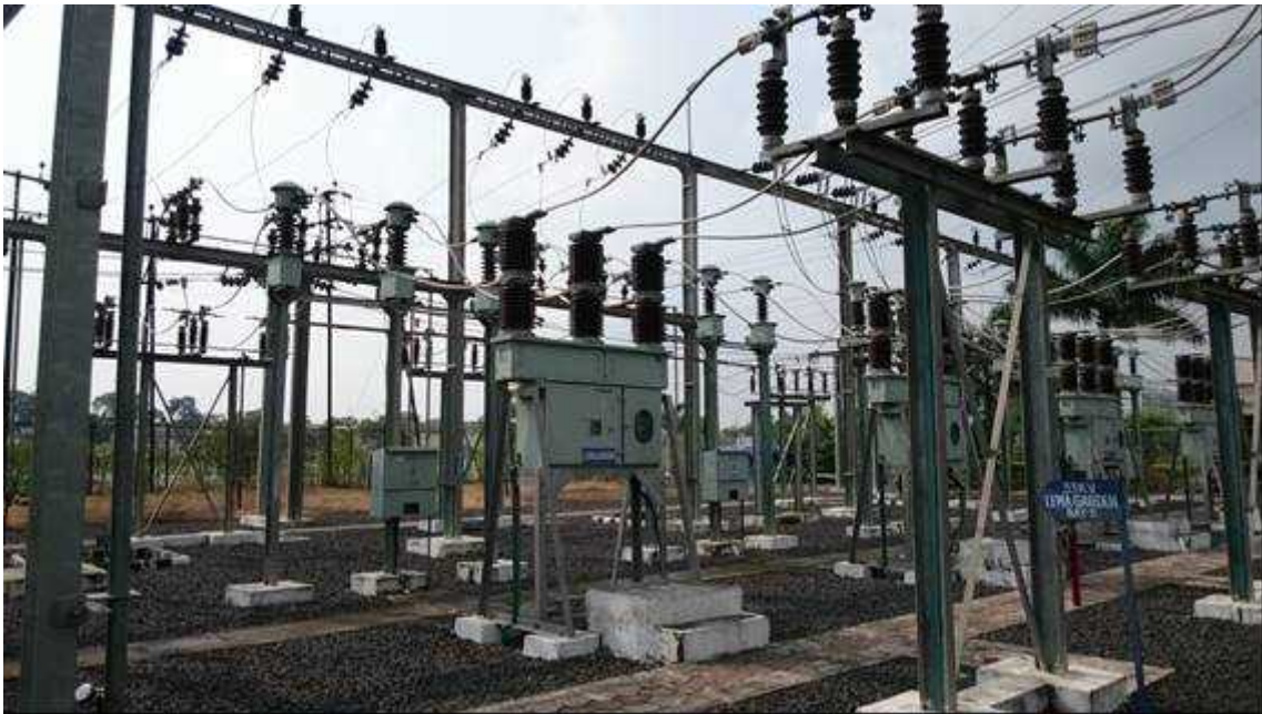
図 2-18 33kV 送電線引出し設備 (Marhotel 132kV 変電所)
