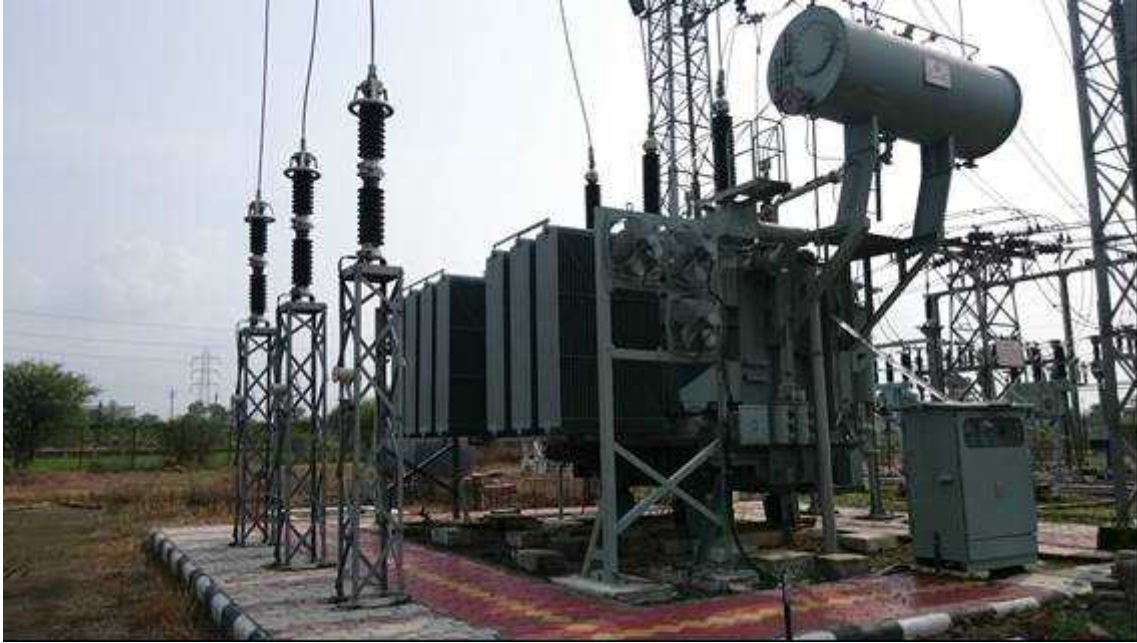
図 2-15 132/33kV, 63MVA 変圧器 (Marhotal 132kV 変電所)
