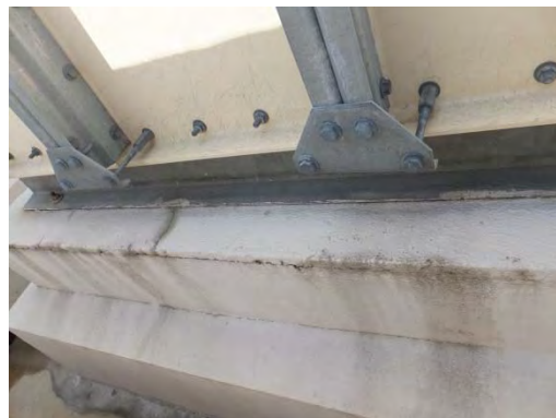
基礎コンクリート表面の変色
