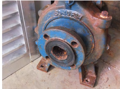
取り外された井戸ポンプ：内部も錆びている
