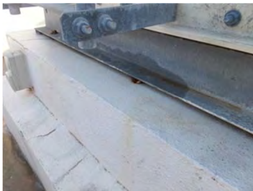
鉄骨表面の湿り、接続ボルトの錆
