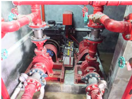
消火用ポンプ（左がディーゼルエンジン駆動ポンプ）
