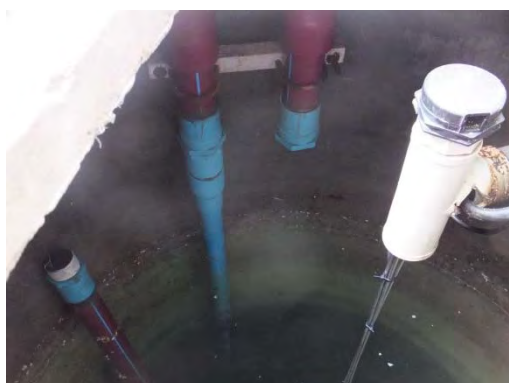
取水管と PVC の接続（漏水のため、今回の現地調査中に撤去）
