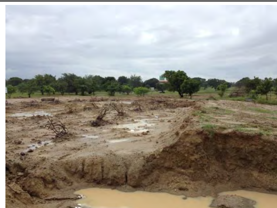
⑭ 講堂建設敷地：インド政府の支援による建設工事が開始された。
