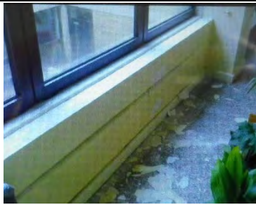
【FD-2】雨漏りにより塗装剥離した状態の写真（学校担当者撮影）。
