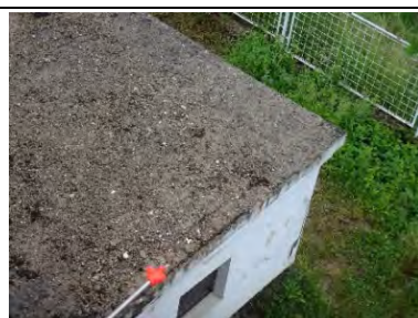
【RS-5】ポンプ室屋根。屋根防水押えコンクリートが劣化しており、鉄筋が露出している。
