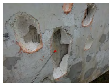
【RS-5】ポンプ室外壁。鳥が断熱材に大きな穴をあけ、コンクリート壁が見えている。
