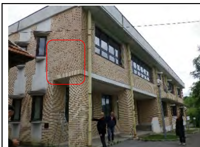
【FD-1】(ア)職員室裏のピロティ。赤枠内のレンガ壁が孕み、壁を受ける臥梁が破断している。
