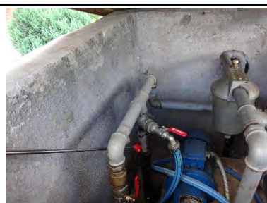
【FD-7】燃料漏れが疑われたため、学校がポンプから給油配管への接続を切り、ホースを使って給油できるように分岐した。
