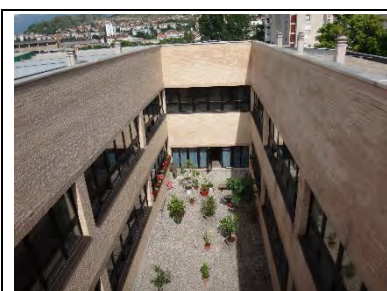
【FD-5】中庭の外壁面は、四周ともレンガ、タイルの剥離、亀裂、落下が生じている。また、不具合が生じている壁面箇所は水が浸みている。
