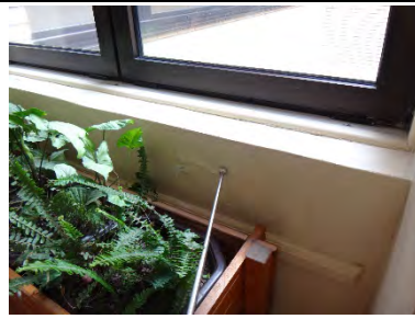
【FD-2】学校による補修後。依然として雨漏りが継続しており、塗装剥離している。
