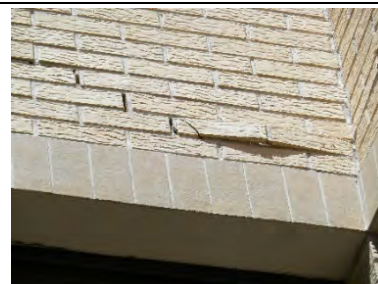
【FD-5】中庭壁面のレンガの表面剥離。
