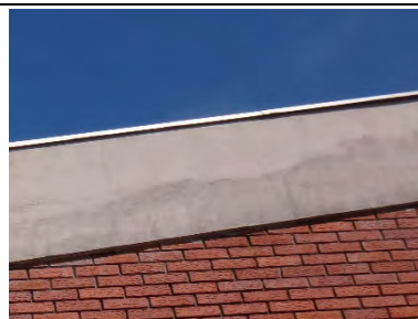
【FD-3】建物正面左側のモルタル補修箇所。多数のヘアクラックがあり、面全体が浮いている。
