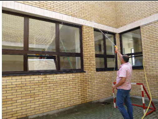
【FD-8】窓周り雨漏り原因・問題箇所特定のための調査
