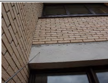
【FD-1】(ウ)2階廊下梁モルタル部の亀裂。
