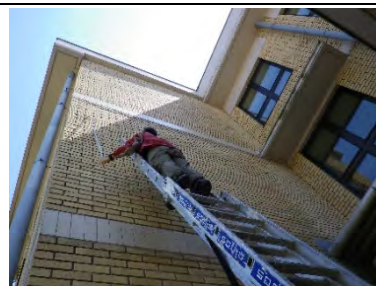
【RS-2】(エ)外壁にトイレからの漏水と思われる水染みがあり、壁面がわずかながら不陸状態である。
