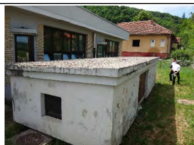
【RS-5】ポンプ室。外装が激しく劣化、損傷している。
