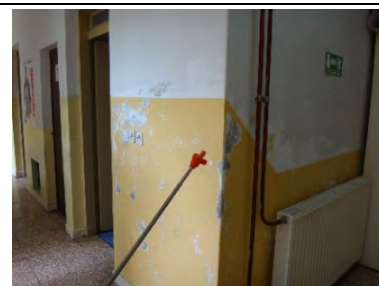
【RS-5】トイレ手洗い用給水配管からの水漏れによると思われる水染み。
