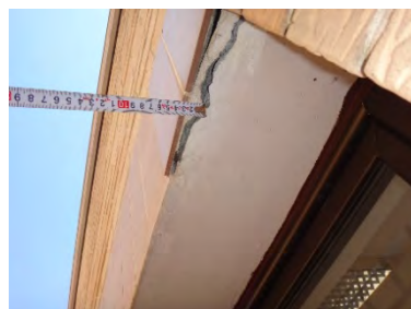
【FD-5】中庭に面した窓上のタイルの一部が、コンクリートと共に浮き上がっている。
