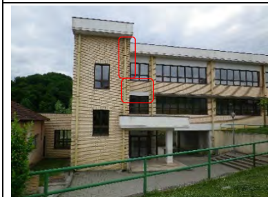
【FD-1】階段室外壁（イ）の一部に孕みが見られる。また、2階廊下梁（ウ）のモルタル部に亀裂が生じている。
