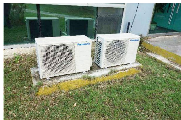
Unidades exteriores de acondicionadores de aire (productos japoneses)
