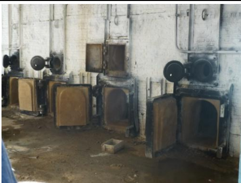
Boca de encendido de caldera
