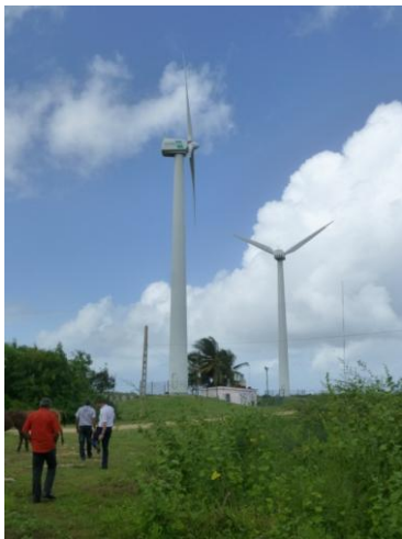
Turbina eólica (240kW × 2 unidades)
