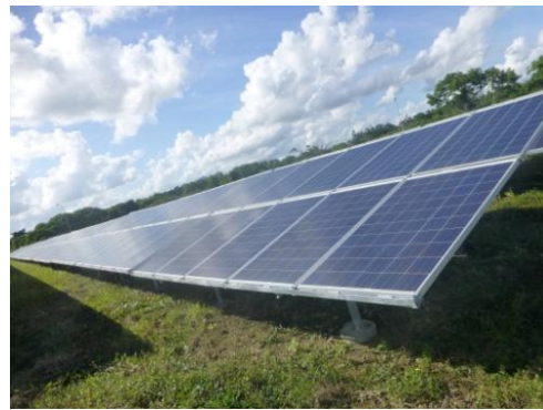
Parque solar Cruces = (3MW)
