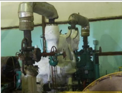
Válvula de vapor
