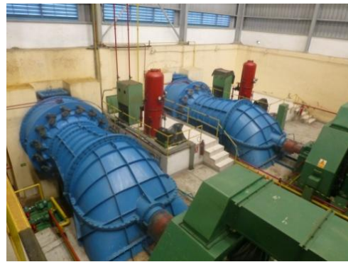
Central hidroeléctrica Zaza: Molino (1.350kW × 2 unidades)
