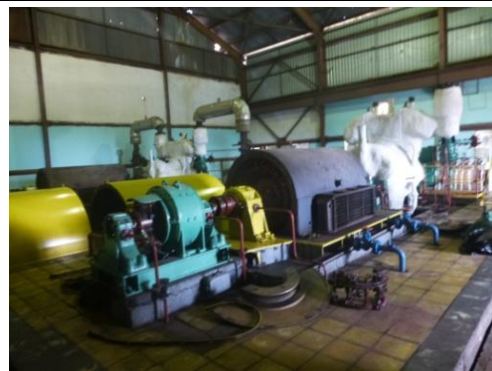
Turbina de vapor y generador eléctrico
