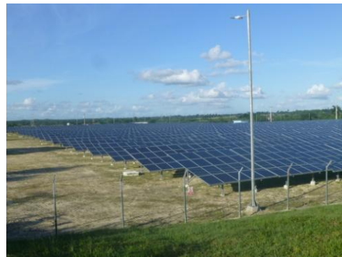
Parque solar Cantarrana (2,6MW)
