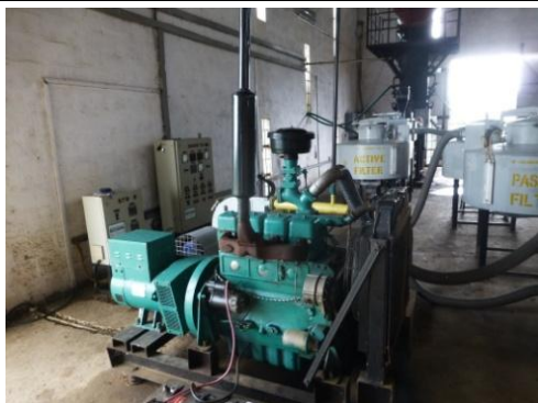
Generador eléctrico con biomasa (30kVA)
