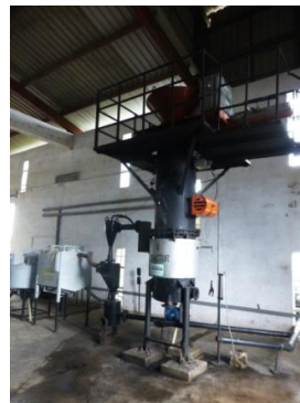
Caldera de gasificación de biomasa madera
