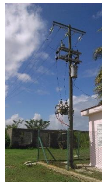
Línea de distribución eléctrica conectado a redes
