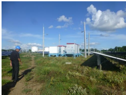
Caseta de control del parque solar Cruces
