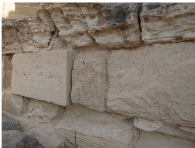
図 2-3 既存壁の風化状況
