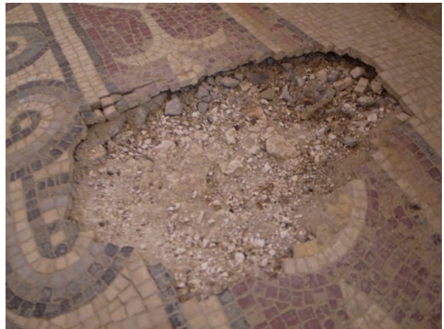
図 2-7 Diwan の床モザイク破損部
