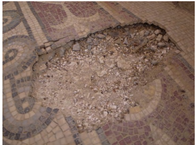
図 2-7 Diwan の床モザイク破損部
