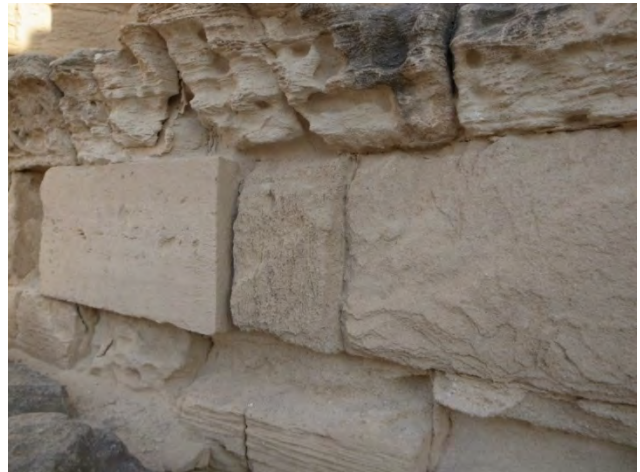
図 2-3 既存壁の風化状況
