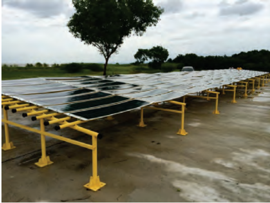
NIFTDC 内に設置した太陽光パネル
