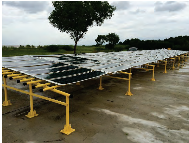
図 10 陸上用太陽光発電システム
