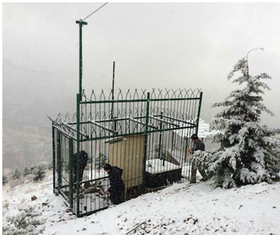
شکل 174.2 تاسیسات در ایستگاه EEW-4 پارک مامدگی رودهن
