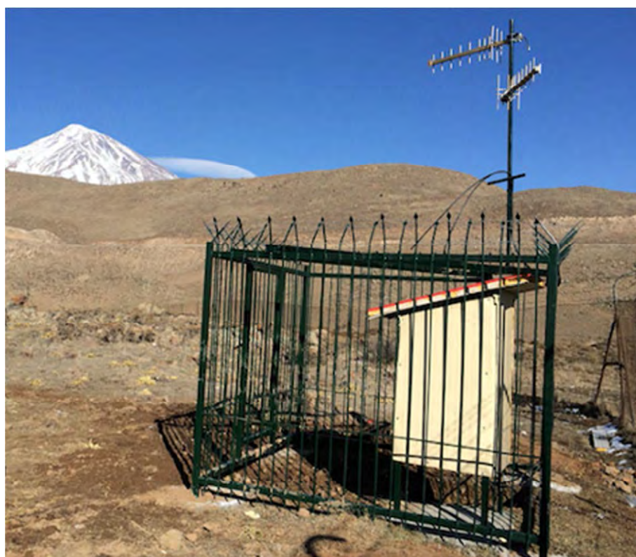
شکل 144.2 سایت ریپیتورها REP-1 در منطقه مسکونی پلور
