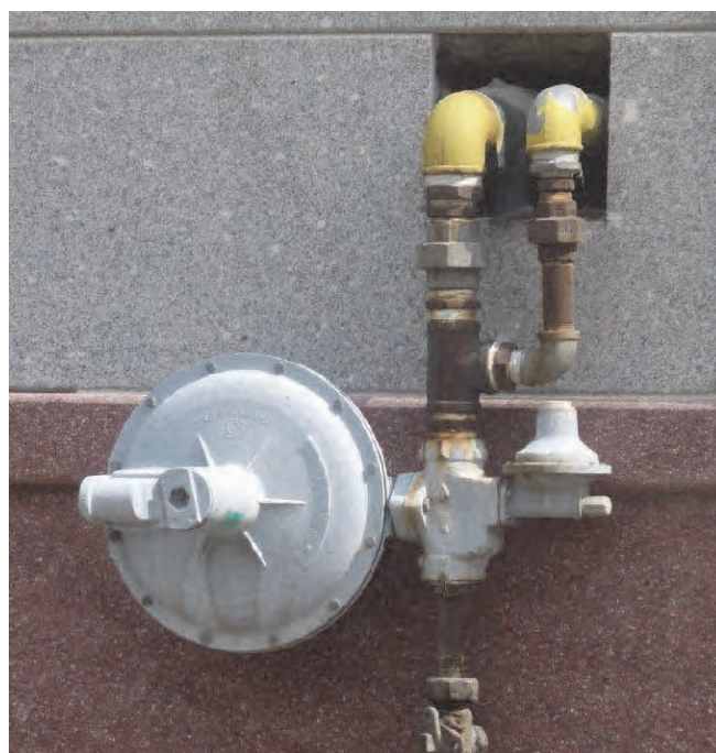
図 2.2.18 家屋に取り付けられた圧力調整のためのレギュレータ
