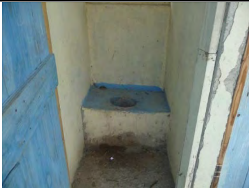
学校番号 9 既存トイレブース(2014年11月14日) 一般的なトイレブース。下部に便槽があるが汲み取りは行われていない。
