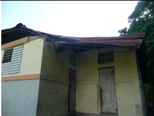
学校番号 18 既存校舎(2014年11月15日) ハリケーンにより損壊した屋根。
