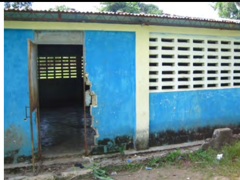
学校番号1 既存校舎(2014年10月25日) 老朽化の著しい教室棟。
