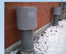
Отверстие для забора воздуха в «холодный коридор»
