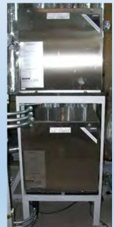
ヒートポンプ
