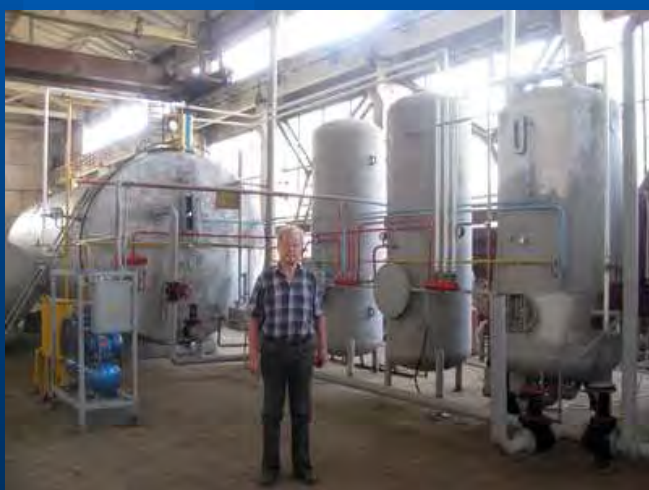
バイオガスプラント
