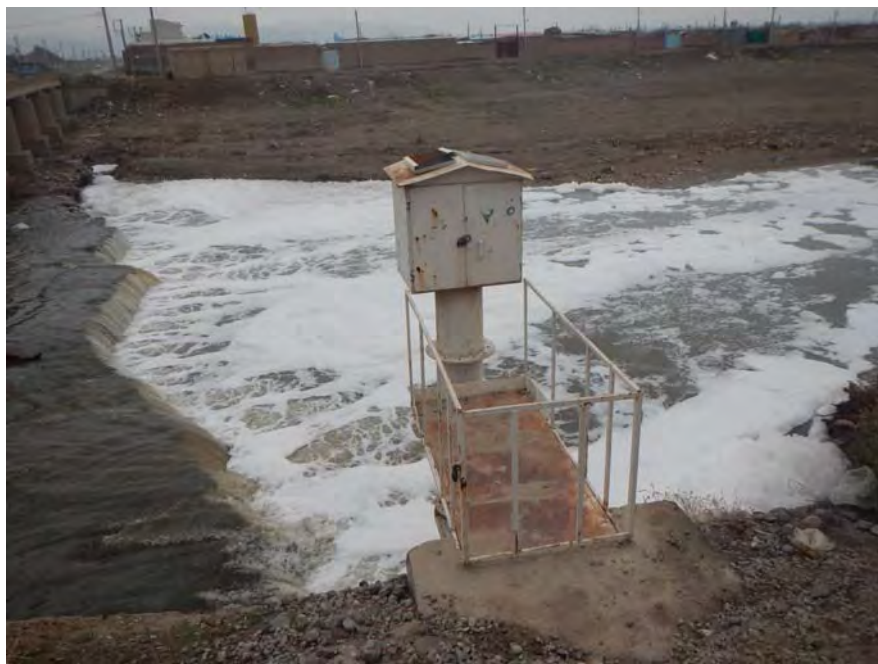
図 3.1.1 流量観測所(Akhola 観測所、Aji Chay 川下流)
