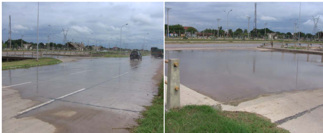
e) Charcos de agua de lluvia en una vía recién construida f) Charcos de agua de lluvia sobre un Puente.
