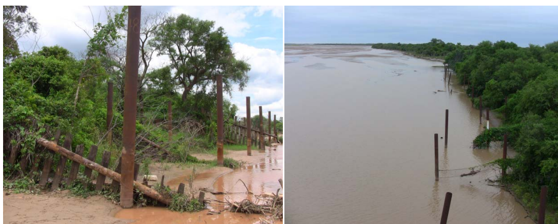
a) Espigones para protección de la orilla del río en las aguas arriba del Río Pirá de la salida del principal del canal de drenaje a lo largo del Octavo Anillo. b) Espigones para la Protección de la orilla del río en aguas arriba del Río Grande en la parte del puente Pailas
