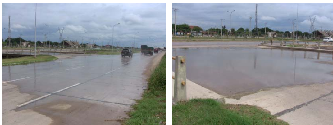
e) Charcos de agua de lluvia en una vía recién construida f) Charcos de agua de lluvia sobre un Puente.
