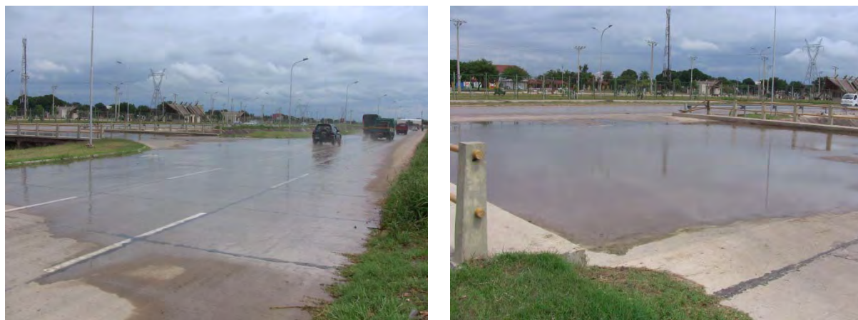
e) 建設されたばかりの道路に見られた水たまり
