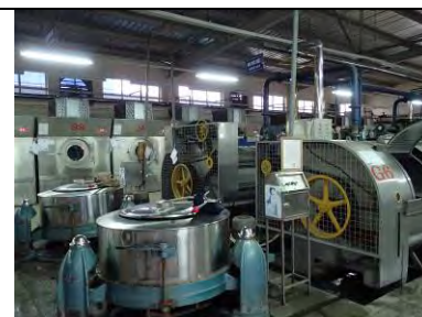
衣料品工場のクリーニング場
