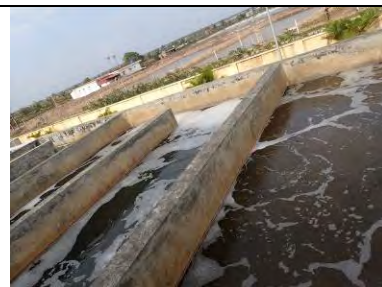
活性汚泥処理槽
