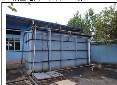
凝集・沈殿槽
