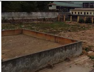
スラッジベット
