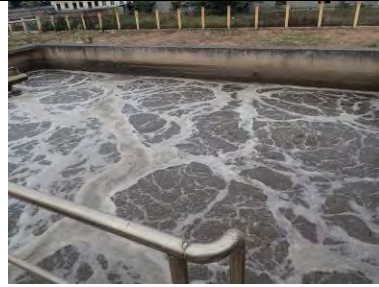
SBR処理槽2 (ばっ気時)
