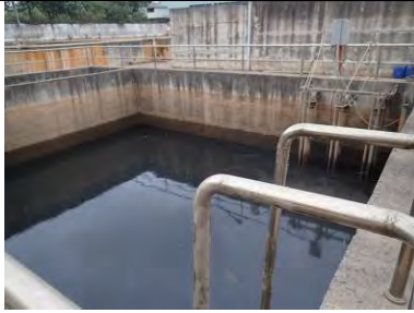
SBR処理槽1 (沈殿時)
