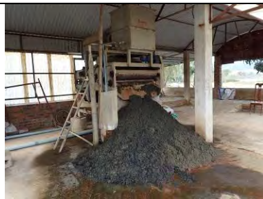
スラッジ処理装置
