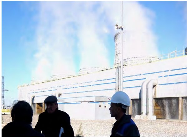
写真 3 ナボイ火力発電所 CCPP 1号機 冷却施設
