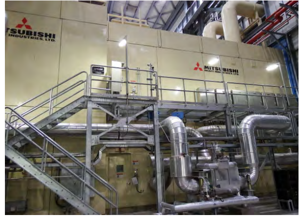
写真 2 ナボイ火力発電所コンバインドサイクル・ガス タービン (CCGT) 1号機
