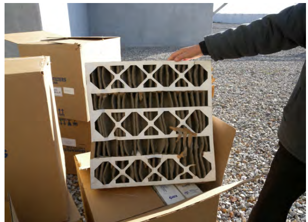
写真 6 CCPP フィルター交換前
