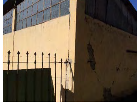
Vista del cuarto de calderos. El fisuramiento estructural ha sido dejados sin atender
