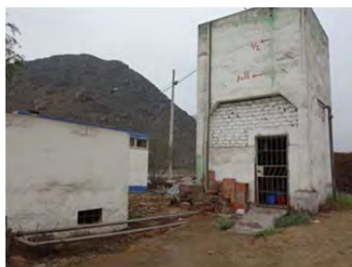
La cisterna fuera de servicio por presentar fisuramiento del concreto
