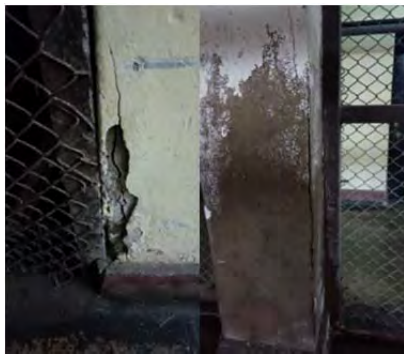
Fisuramiento estructural del sótano
