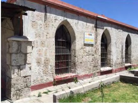
Vista de la mampostería en sillar, la diferencia del color demuestra las huellas de reparación
