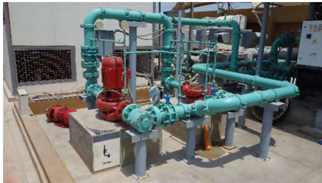
Unidad de refrigeración instalada en la azotea del Hospital Regional Lambayeque (Empresa canadiense Trane), no llegan repuestos de bomba.
