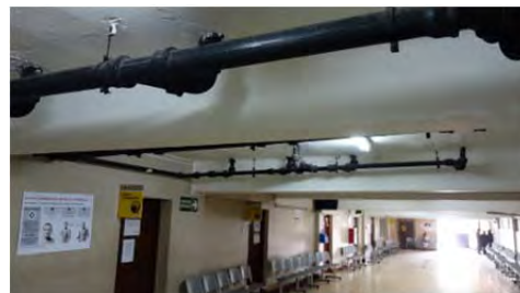
Tubería de desagüe expuesta en el pasillo de la sala de espera de la consulta externa
