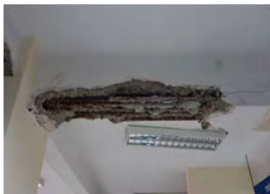
Desprendimiento de concreto armado por la oxidación de estructura de acero
