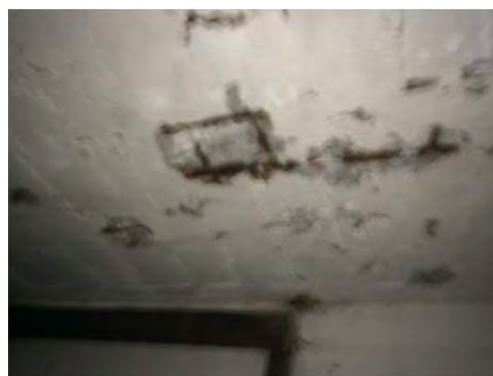
Desprendimiento de la losa de concreto armado por oxidación de las varillas de acero estructural
