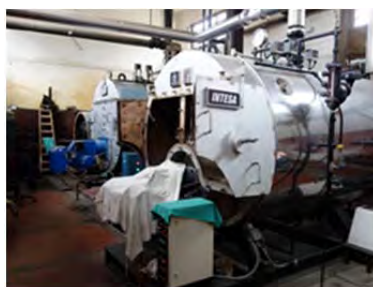
2 calderas, la delantera está en reparación
