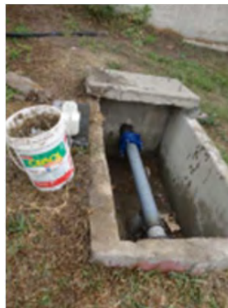
Tubería de alimentación de agua de la red público
