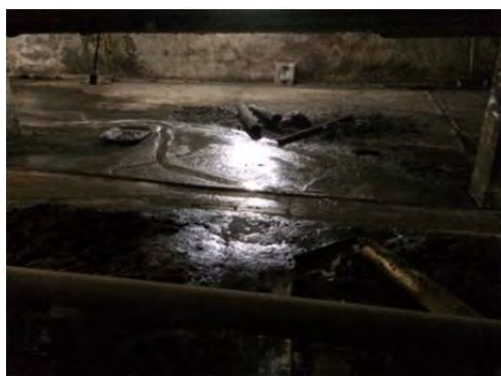
Rasgos de los daños de filtración de agua en el sótano
