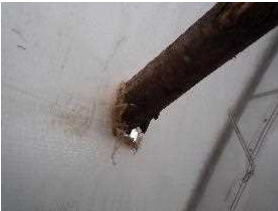
支柱がビニールを突き破る様子
