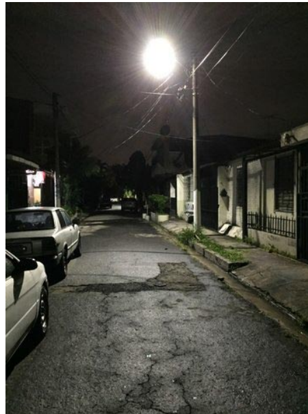
Foto 2-4 Lámpara de LED instalada (de noche)
