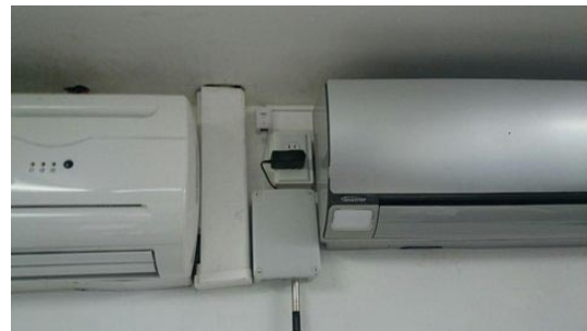
Foto 2-8 AC instalado en CNE
