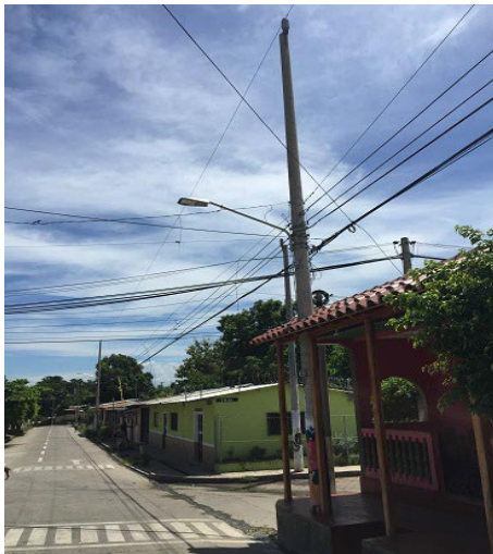
Foto 2-1 Lámpara de LED instalada (de día)
