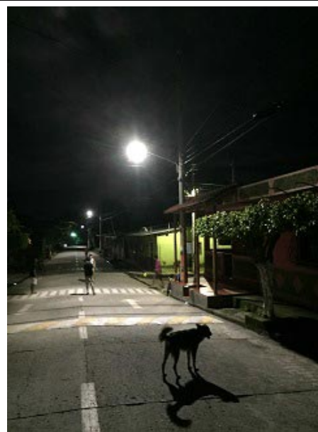
写真 2-2 LED 街灯設置状況（夜間）
