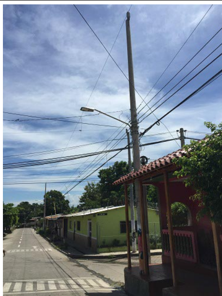
写真 2-1 LED 街灯設置状況（日中）
