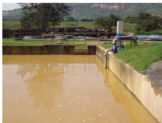
写真 3. Nzove 浄水場の水槽
