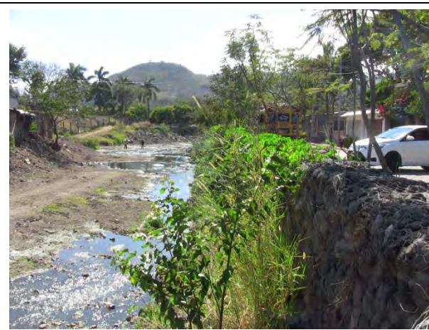
Foto N8.2: Río Grande: Ejecución de las excavaciones anuales del cauce desde el año 2011 y obras estratégicas ante la erosión de las orillas del río (Obras de cesta de serpiente).
