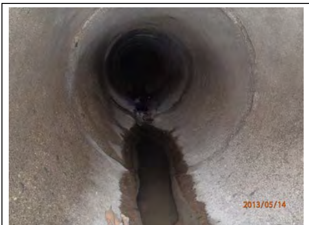
Foto E7.3: Situación de las tuberías en cercanías de los puntos de hundimiento. Se encuentra erosión en el fondo de la tubería generando hoyos (May. 14, 2013)
