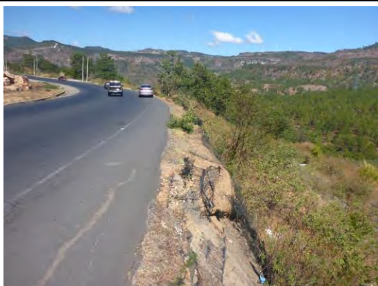
Foto H4.1: Se encuentra derrumbado el suelo reforzado del lado valle de la vía. La longitud total del daño es de 200m. (Feb. 23, 2015)
