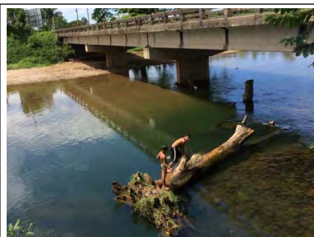
Foto H8.2: Puente Tocoa Se ha disminuido el espacio bajo las vigas. Existen las posibilidades de que maderos flotantes aún más grandes fluyan por la corriente.
