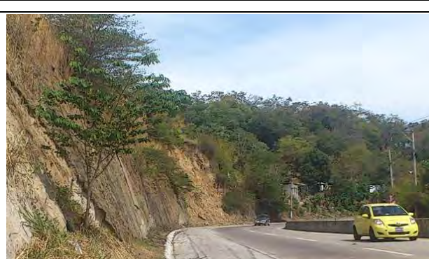
Foto E5.12: Pendiente 7, pendiente al costado del carril de bajada (Altura máxima de la pendiente 11m, altura promedio de la pendiente 10m, longitud total de la vía de la pendiente 75m), pendiente de roca blanda – tierra eólica, la parte de roca blanda se encuentra estable en general, sin embargo está avanzando el derrumbe en la parte de tierra eólica, Longitud de superficie 18km+500m (Mar. 14, 2015)
