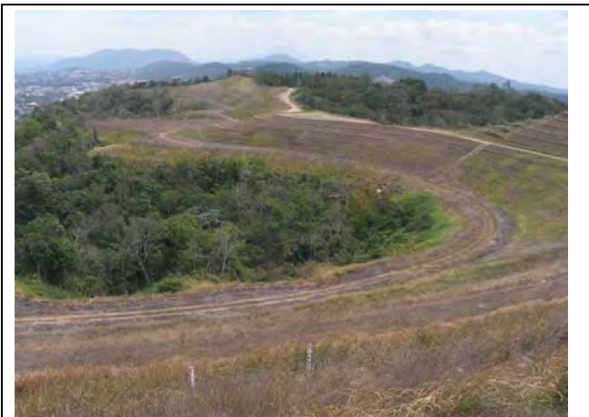
Foto E2.4: Situación de la eliminación de la tierra en la parte superior, Foto suministrada por el profesor FUKUOKA, Hiroshi
