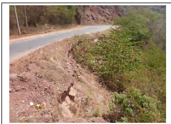
Foto H1.6: Situación del deslizamiento de la parte superior Al retrocederse el deslizamiento, la vía sufriría mayores daños. (Mar. 6, 2015)
