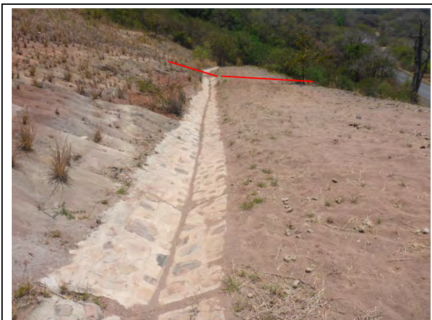
Foto N1.9: Empuje de los canales (Línea roja al costado derecho del deslizamiento) (Mar.16, 2015)
