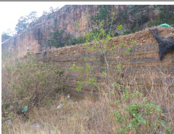
Foto H4.5: Situación de daños en el suelo reforzado (Feb. 23, 2015)
