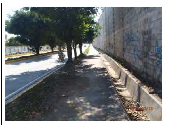
Foto E3.6: Depresiones de inundación habitual y canales laterales de Boulevard Sur (Feb. 18, 2015)
