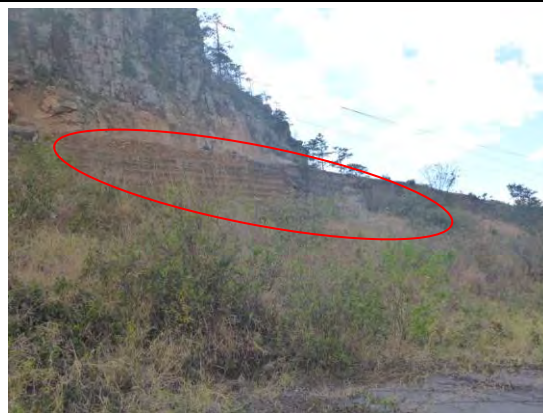
Foto H4.2: Derrumbe del suelo reforzado a distancia. Se encuentra el desvío del pasado y el desvío se encuentra trasladado al valle. (Feb. 23, 2015)
