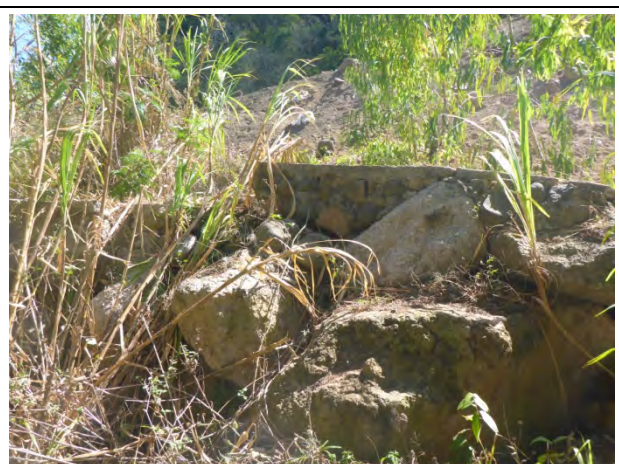
Foto N4.5: Muros de contención de concreto construidos al costado de la vía. Sufre daños por la actividad de los deslizamientos. (Mar.16, 2015)
