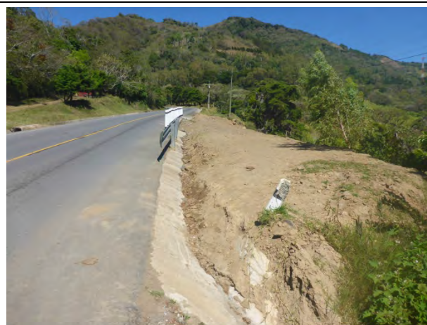
Foto N4.2: Situación de la parte superior del deslizamiento. Se están realizando trabajos de emergencia por FOMAV. En las épocas de lluvia el relleno se hunde y se lo lleva la corriente. (Mar.16, 2015)
