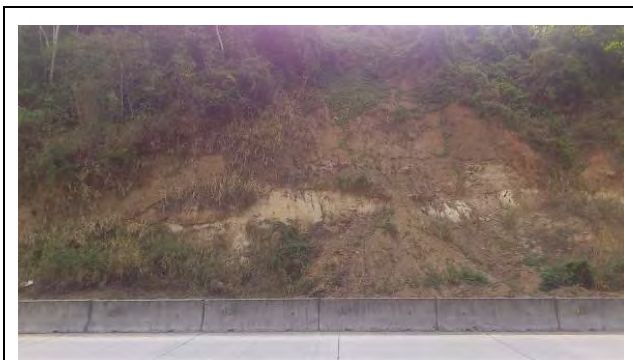
Foto E5.1: Pendiente 1 Pendiente del costado de subida (Altura máxima de la pendiente 21m, altura promedio de la pendiente 15m, longitud total de la vía de la pendiente 100m), pendientes de roca blanda desgastada, longitud de superficie 14km+500m (Mar. 14, 2015)
