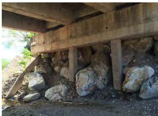
Foto H7.3: Puente Pires, se dañaron las vigas del contrafuerte y se perdieron. SE encuentran controlando la parte trasera de contrafuertes con piedras gigantes, sin embargo esta no es una estrategia de solución.
