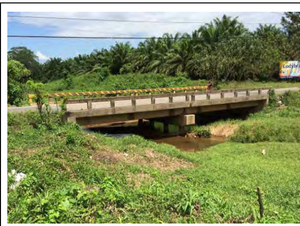
Foto H8.4: Puente Pires No. 2 Debido a que las zonas aledañas al puente son de baja latitud se inundan en momentos de inundaciones. Cuenta con el mismo sistema hídrico que el puente Tocoa y se puede pronosticar que las inundaciones se deben al aumento del nivel de agua del río Tocoa.
