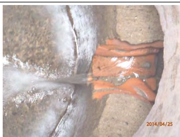
Foto E7.4: El cemento de la superficie al interior de las alcantarillas se encuentra erosionado. (Abr. 25, 2014)
