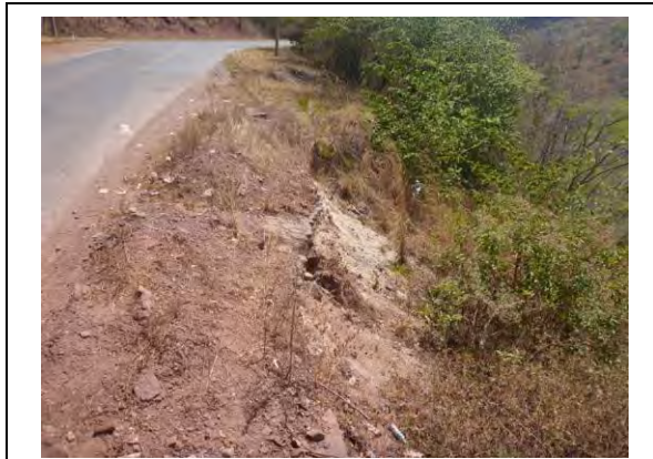
Foto H1.2: Situación de deslizamiento de la parte superior. La parte superior del deslizamiento se ubica en cercanías del arcén. (Mar. 6, 2015)
