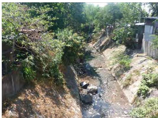
Foto E1.11: Vista del costado del curso inferior desde la vía 27 Avenida Norte. Situación del canal de agua. Se determina la insuficiencia de la sección transversal de la hidrobia (Marzo 24 de 2015)
