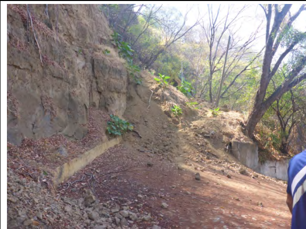
Foto N3.1: La tierra derrumbada cubre las vías de gestión de mantenimiento. (Mar.13, 2015)
