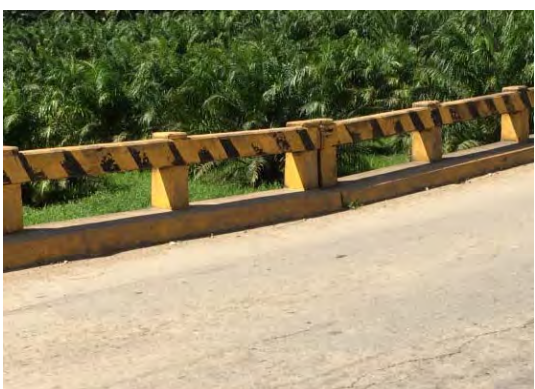
Foto H5.5: Puente Alivio del Aguan No.4, Debido al hundimiento las barandillas y superficie de la vía se encuentran refractadas en depresión.
