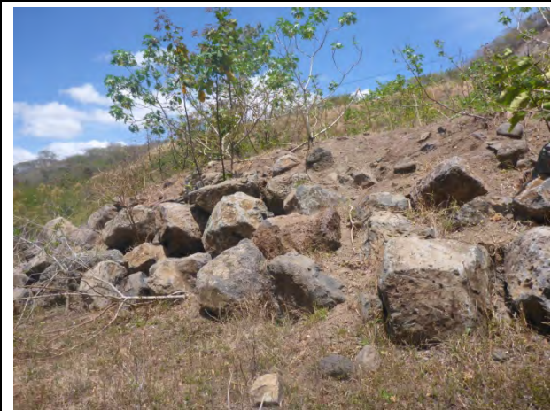
Foto N1.13: Situación de cercanías a los extremos Se encuentran instaladas rocas (Mar.16, 2015)
