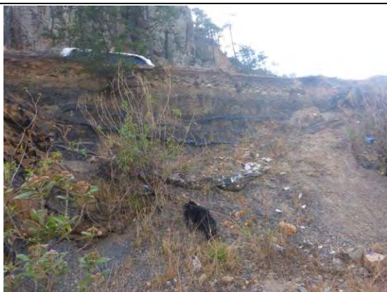
Foto H4.3: Derrumbe del suelo reforzado, se encuentra descubierto el geotextil. (Feb. 23, 2015)
