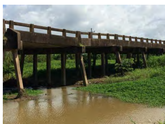
Foto H5.4: Puente Alivio del Aguan No. 4 Situación de descenso del suelo de los pilares. Debido a l hundimiento, las vigas se encuentran refractadas en depresión.
