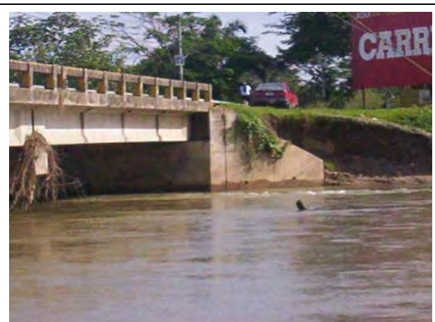
Foto H8.3: Puente Tocoa Situación del decapado de contrafuertes (lado Tocoa) al momento de la inundación. En el año 2009 se derrumbó la parte trasera del contrafuerte.
