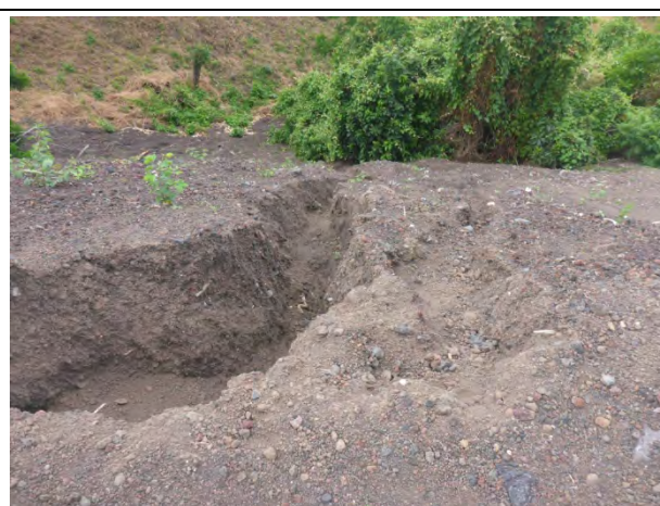
Foto E4.8: Grietas presentadas en los diques, se puede determinar que es demasiado apremiante la inclinación de la pendiente (Mar. 25, 2015)
