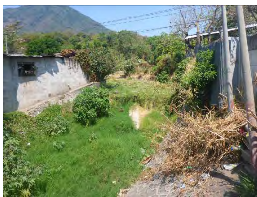
Foto E1.10: Vista del costado del curso superior desde la vía 27 Avenida Norte. Situación del canal de agua, se determina la insuficiencia transversal. (Marzo 24 de 2015)
