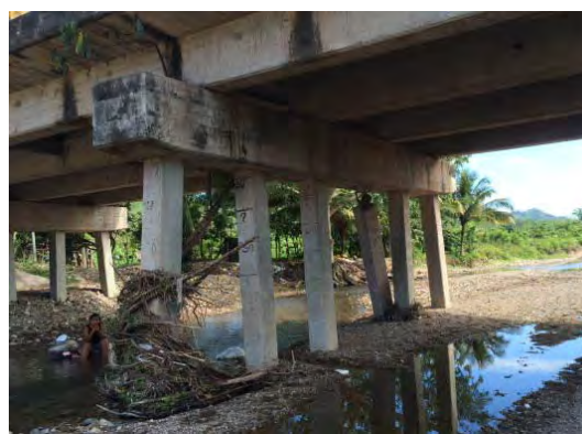
Foto H7.4: Puente Pires Se perdió una viga del pilar del puente. En la parte con corriente rápida son frecuentes los casos de presentar daños por choques de piedras gigantes entre otras. Se realiza el cambio de los pilares de concreto fuerte.
