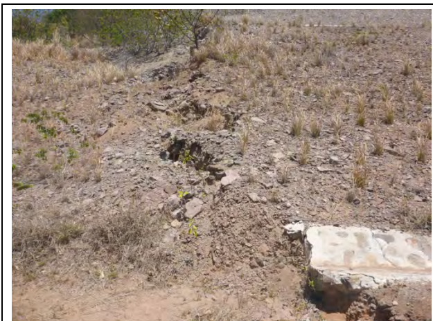
Foto N1.11: Grietas al costado derecho del deslizamiento (Mar.16, 2015)
