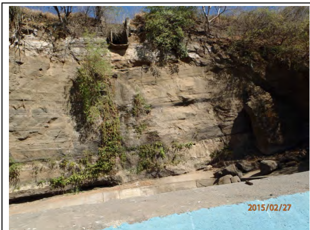
N5.3: Lugar de derrumbe Tomado de la parte inferior del derrumbe (2015/2/27)
