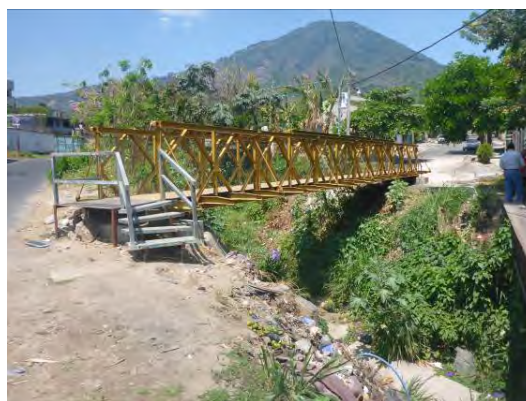
Foto E1.12: Puente provisional de Calle Sevilla que cruza la calle principal entre la vía 27 Avenida norte y el Boulevard Constitución. Fue llevado por el derrumbe y construido provisionalmente (Marzo 24 de 2015)
