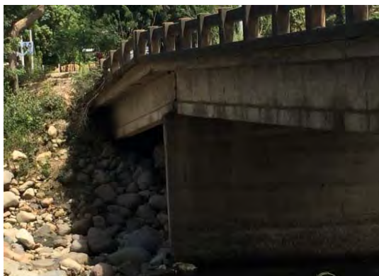
Foto H6.3: Puente Taujica Situación de la caída de las vigas del contrafuerte. Se encuentra protegiendo la orilla con rocas gigantes y debido a esto se disminuye la sección transversal de la vía fluvial.
