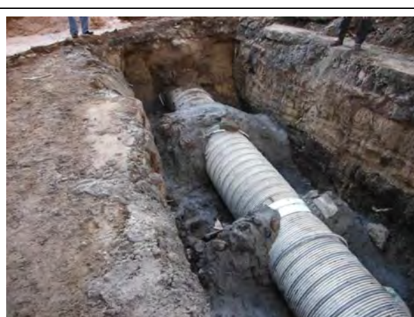
Foto E7.6: No se encuentra asegurada la calidad suficiente en las obras de cambio de tuberías de drenaje (Octubre 2012)
