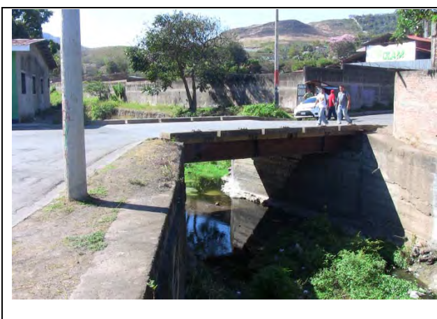
Foto N8.5: Puente en el río Mala, afluente derecho del río Grande, zona estrechada en que se presentan inundaciones y desbordamientos.
