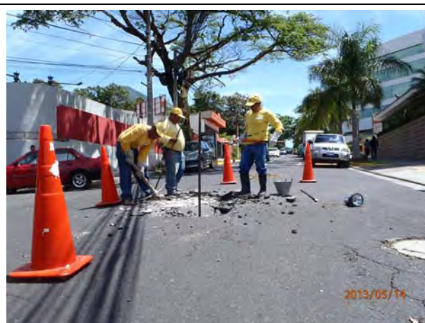
Foto E7.2: Operaciones de cambios de tuberías de drenaje de aguas pluviales en cavidades subterráneas sobre las vías (May. 14, 2013)
