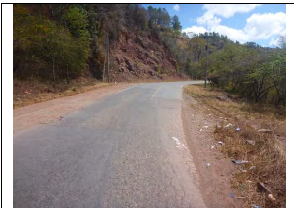
Foto H1.3: Situación del punto final Toma desde el punto inicial Se encuentra hundida la vía por 80m de longitud. (Mar. 6, 2015)
