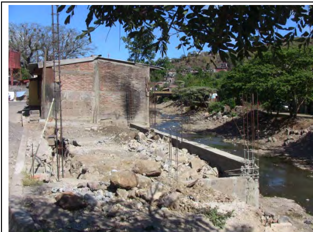
Foto N8.1: Viviendas a lo largo del río Grande: Daños por pérdidas de la corriente en el año 2014.
