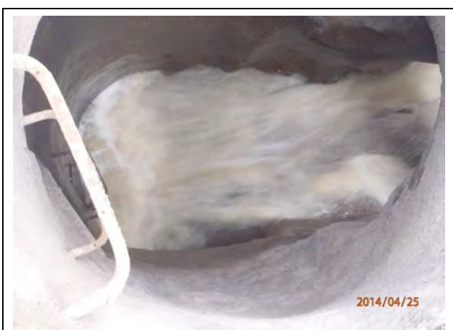
Foto E7.5: La inclinación de las tuberías es apremiante, con fuerte corriente al interior de las tuberías en momentos de lluvias, impactando las paredes de las tuberías (Abr. 25, 2014)
