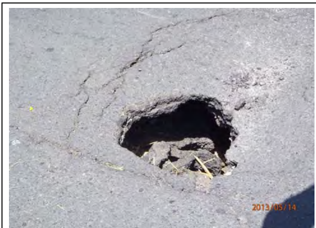
Foto E7.1: Hundimientos en parte del techo de las cavidades subterráneas en la vía norte 89 de la zona Escalón (May. 14, 2013)
