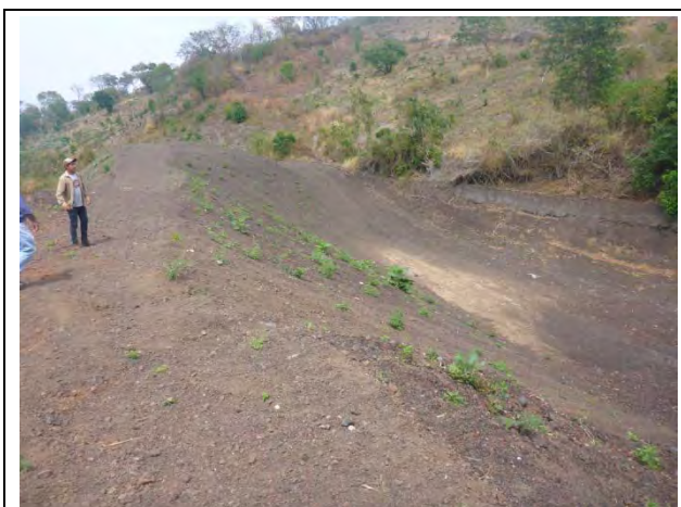
Foto E4.5: Embalse de prevención de erosión construido con materiales generados localmente, Filtración de agua en la parte baja al fondo (Mar. 25, 2015)
