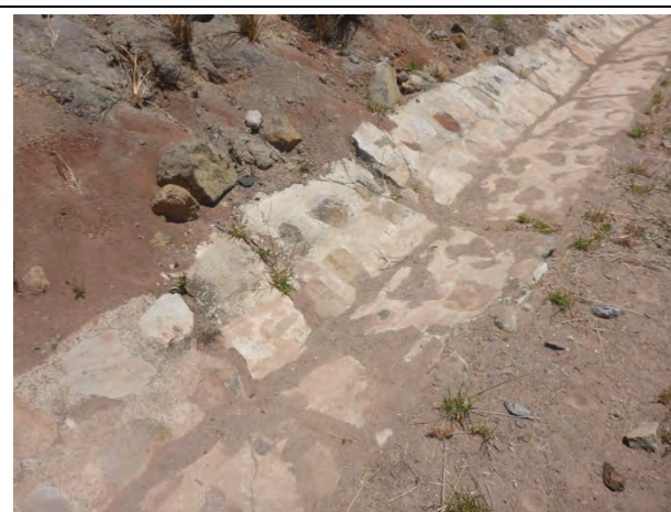
Foto N1.8: Grietas en el pequeño escalón (Mar.16, 2015)
