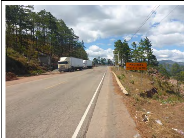
Foto H2.3: Situación de la superficie de la vía Se encuentra hundida la superficie de la vía, los vehículos transitan disminuyendo la velocidad. (Mar. 6, 2015)
