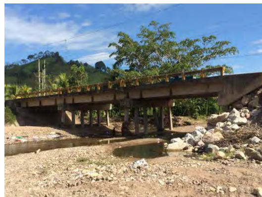
Foto H7.2: Situación de los daños de contrafuertes del lado Saba del puente Pires, se protege la orilla por piedras grandes.
