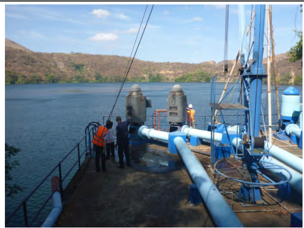
Foto N3.4: Bombas y tuberías de suministro de agua objeto de conservación (Mar.13, 2015)
