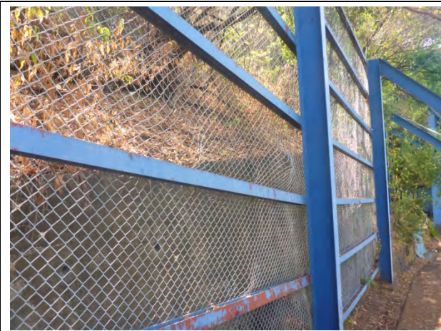
Foto N3.3: Deformación de la malla debido a la caída de rocas (Mar.13, 2015)
