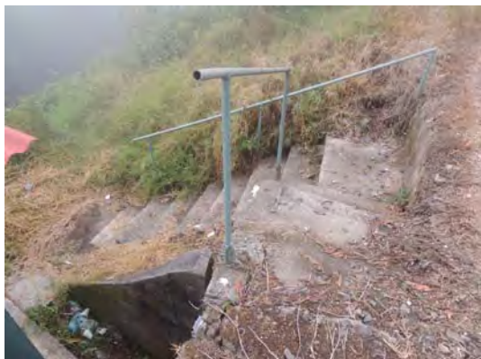
Foto E1.1: Parte superior de la fuente de la quebrada Las Lajas. Se verifica la aparición de grietas por el arrastre de la inclinada pendiente (Movimiento del suelo menor a 1cm por año) (Abril 15 de 2015)
