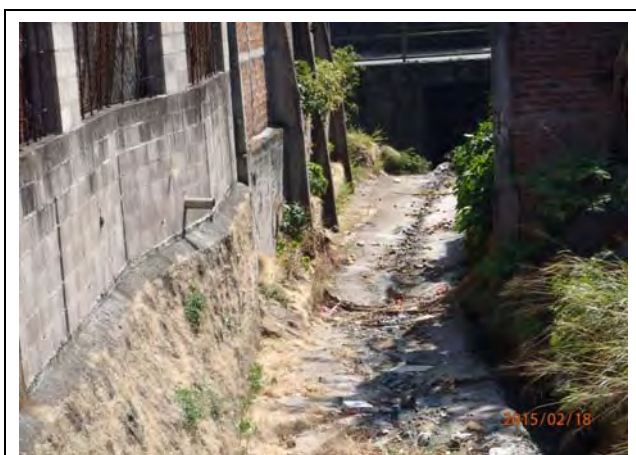
Foto E3.4: Parte de los canales abiertos de la quebrada el Piro, curso inferior de la Foto E3.2 (Feb. 18, 2015)
