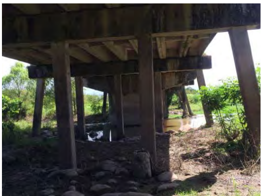
Foto H5.3: Puente Alivio del Agua No. 4 Situación de los pilares del lado Puerto Castilla. Tendencias de hundimiento por el decapado en parte de las pilas curvas. Inestables los sub pilares
