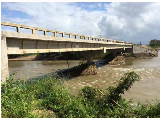
Foto H5.6: Puente Burra, vista del puente. Se desvía la corriente del río Aguan hacia es te puente.
