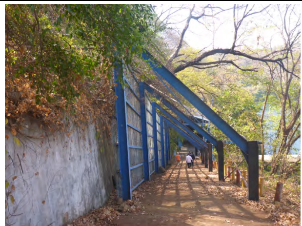
Foto N3.2: Vallas de proyección de la caída de piedras instaladas por la dirección de control de agua (Mar.13, 2015)
