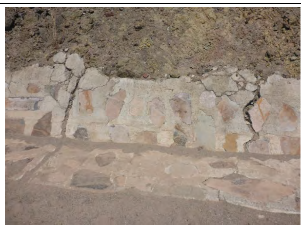
Foto N1.6: Grietas en el pequeño escalón (Mar.16, 2015)
